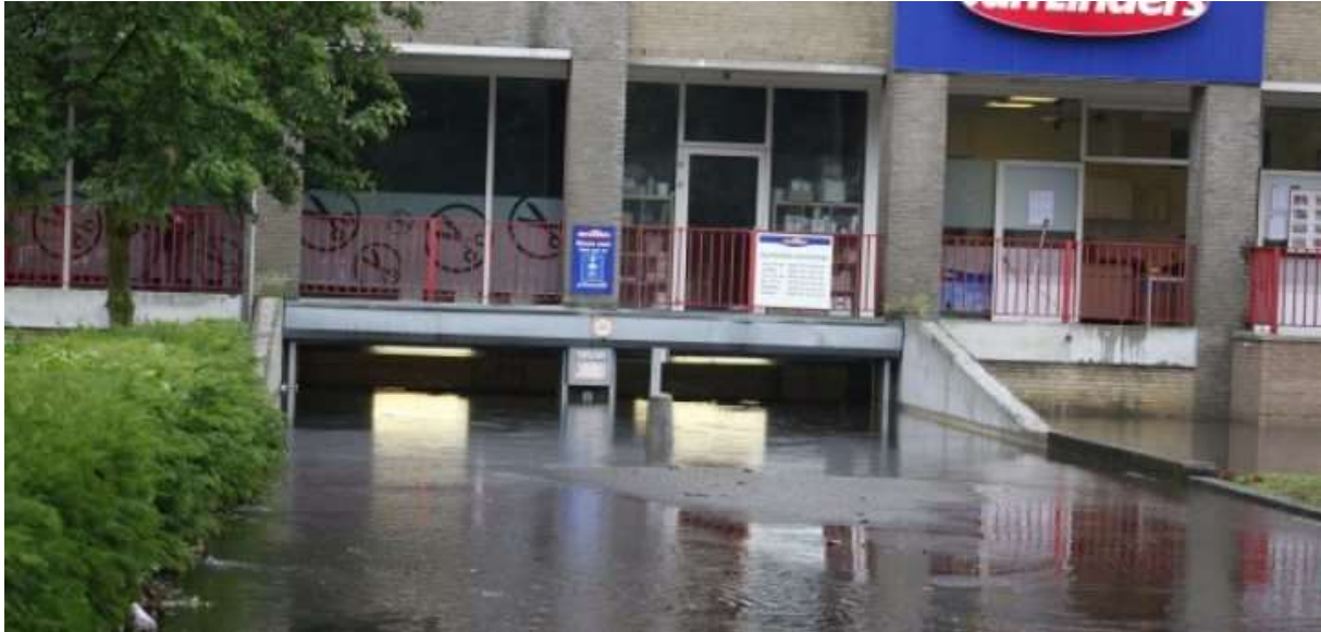
Figuur 3: Volgelopen parkeerkelder na overstroming in Boxmeer, 3 juni 2016. Bron: nu.nl
