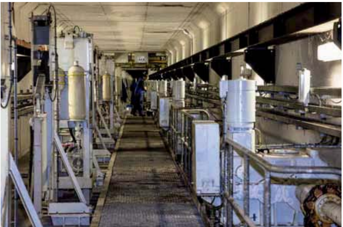
Krammersluizen-pompen om zoet van zout water gescheiden te houden bij schutten binnenvaartschepen
