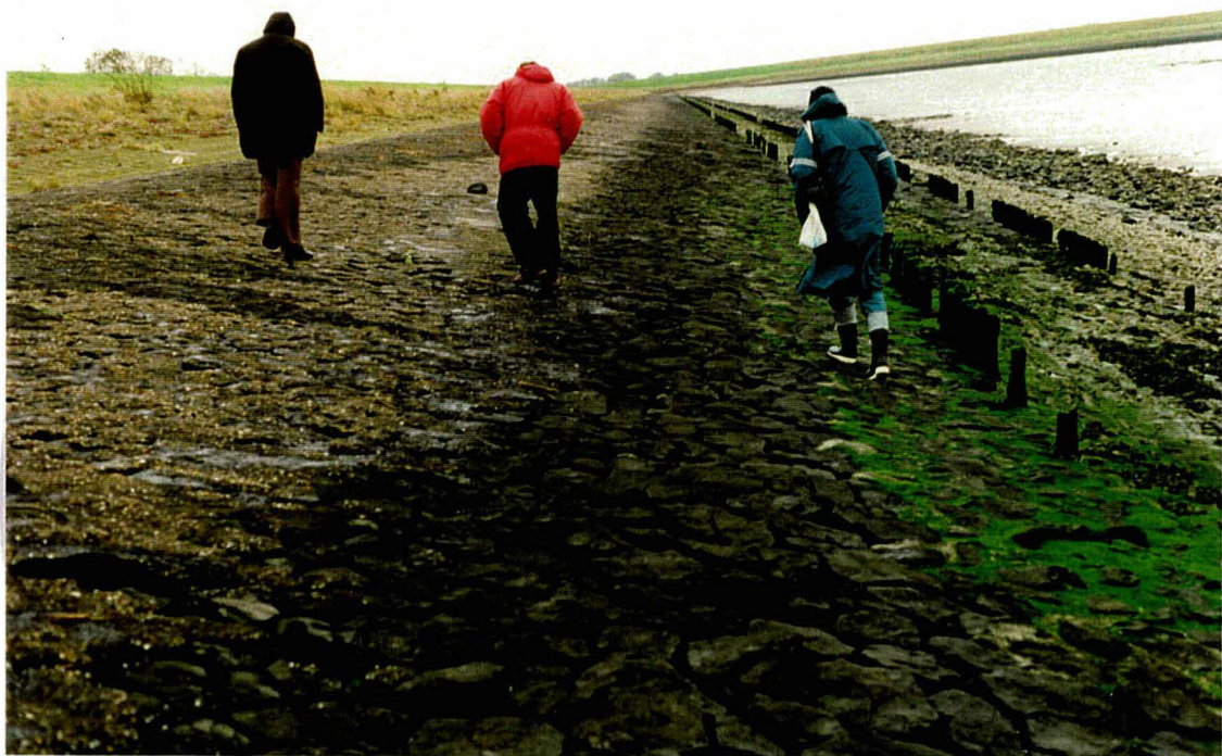
Foto 26 Overzicht bekledingen 18901 (strook met beton geopenetreerde basalt boven de palenrij) en 18604 (met asfalt geopenetreerde basalt aan de bovenzijde)
