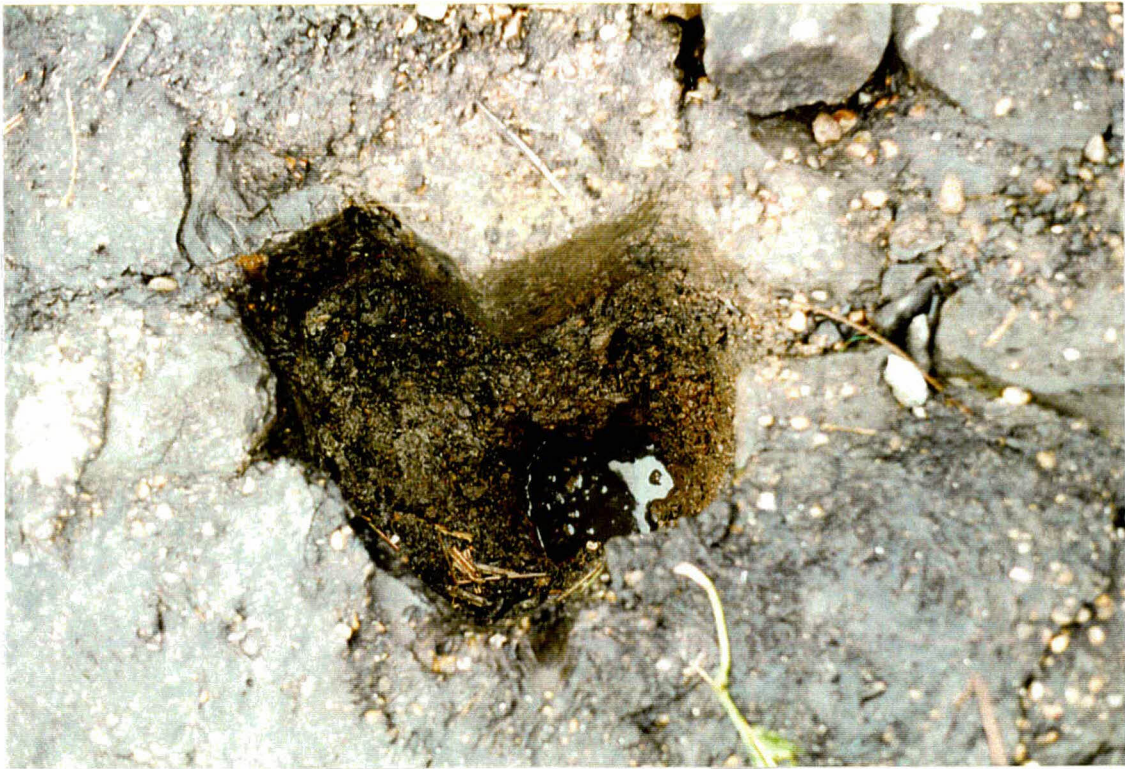
Foto 19 Gat in bekleding 19402 bij km 19,5.
