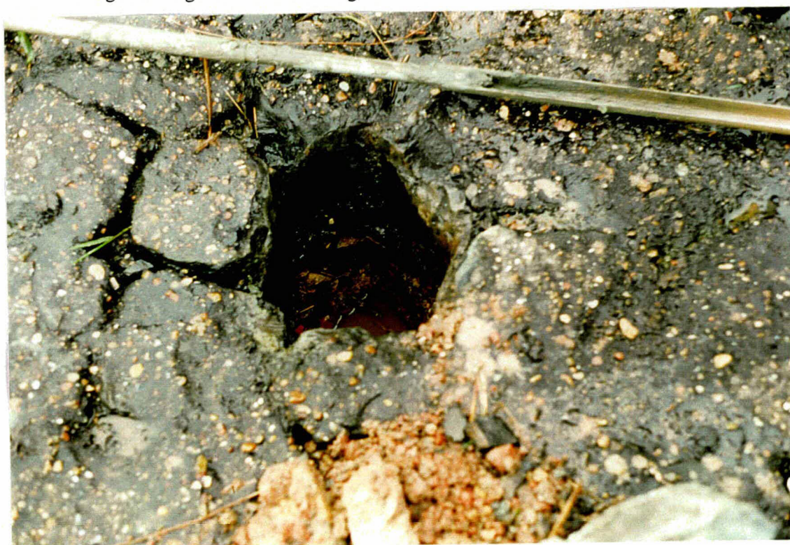
Foto 22 Gat in bekleding 19201 bij km 19,4 hoog op het talud. Het dunne puinfilter oogt wel ingezand, maar er blijkt toch een grote doorlatendheid aanwezig te zijn.
