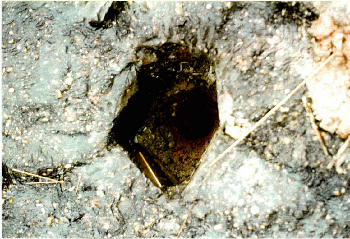
Foto 15 Gat in bekleding 19402 bij km 19,75 hoog op het talud.
