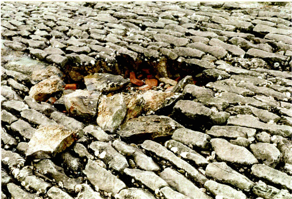
Foto 20 Stormschade in de Vilvoordse steen bij km 19,5.
