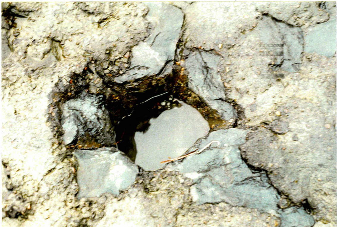
Foto 16 Gat in bekleding 19402 bij km 19,75 laag op het talud. Het gat staat nog vol met water, hoewel het al laag water is.
