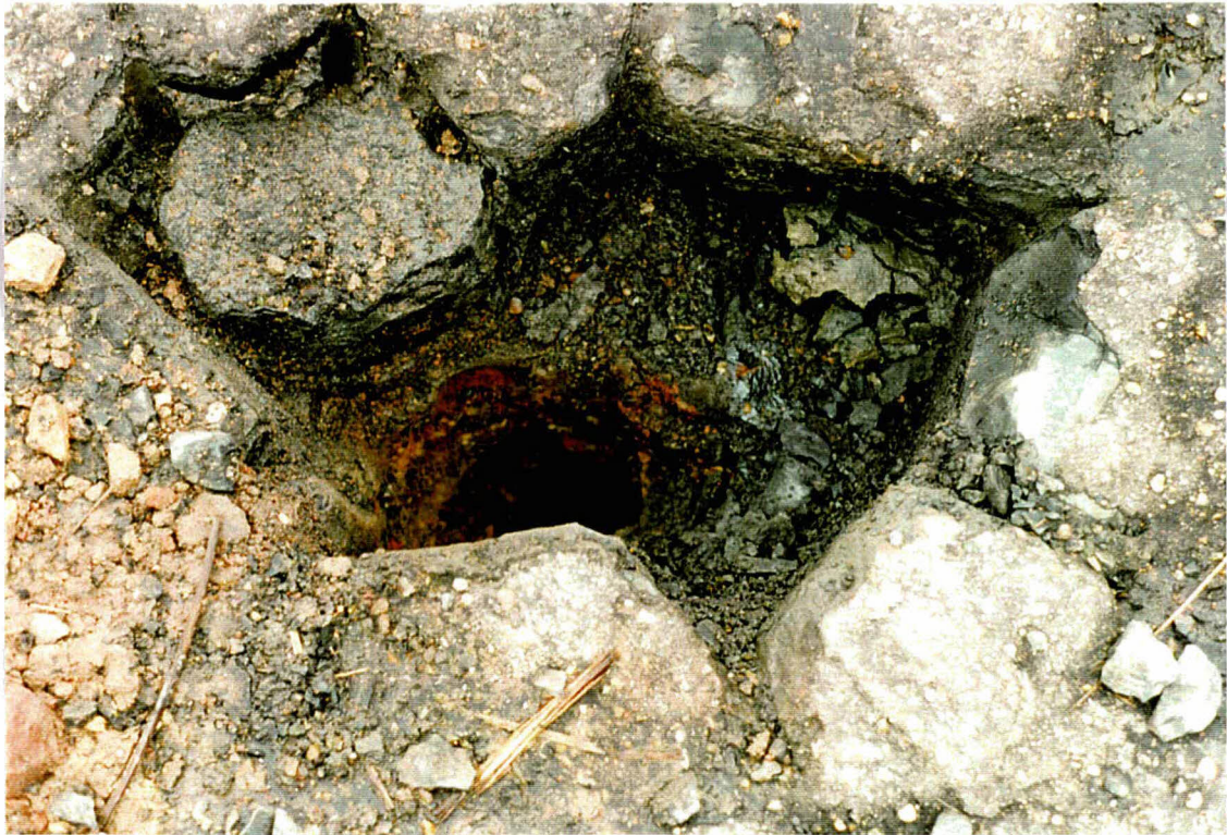
Foto 25 Gat in bekleding 19201 laag op het talud. De penetratie zit tot op het filter.
