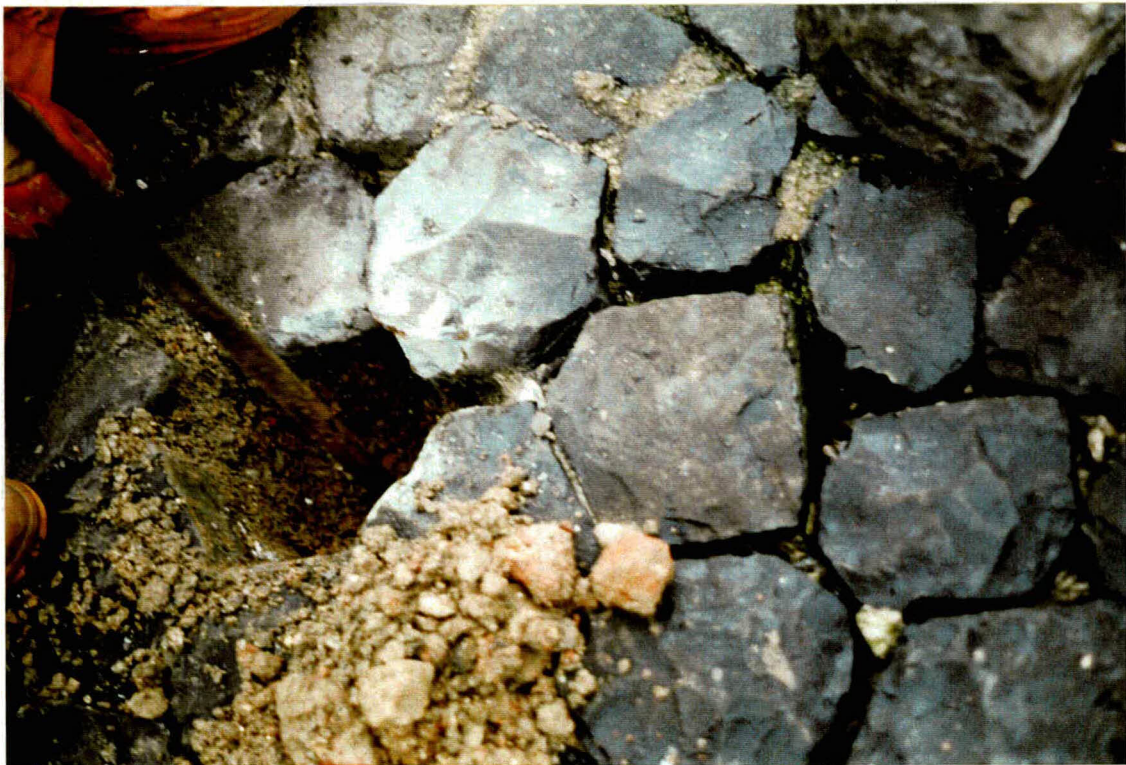
Foto 10 Gat in bekleding 22006. De betonpenetratie lijkt maar sporadisch aanwezig te zijn. Er is wel sprake van inzanding.
