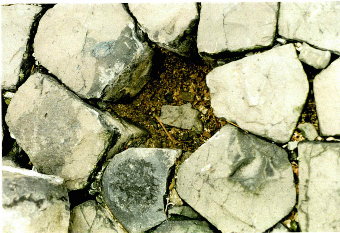
Foto 38 Bekleding 18604. Op het niet geopeneteerde stuk lijkt nauwelijks een filter aanwezig. Het filter is ondoorlatend: water dat in het gat wordt gezet zakt nauwelijks.
