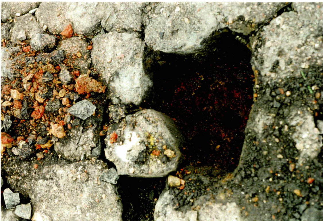
Foto 32 Gat in bekleding 18604 bij km 19. Ingezand filter. De penetratie is tot onderin de spleten aanwezig.
