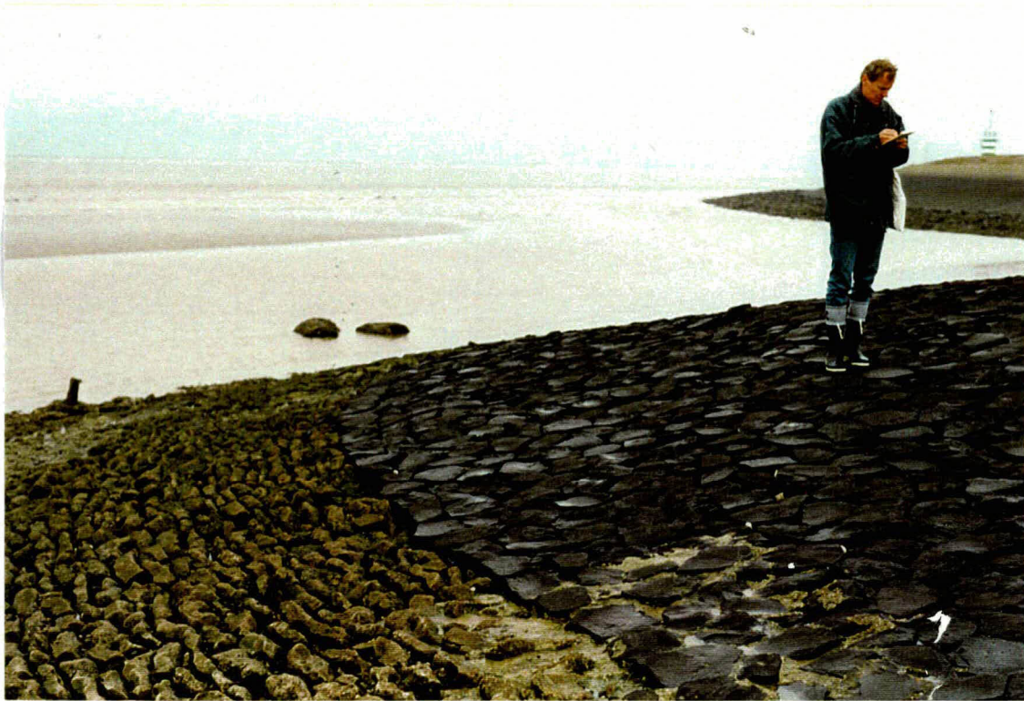
Foto 1 Basalt, bekledingnummer 22503, in de bocht richting de strekdam. Onder de basalt zit met beton geopenetreerde Vilvoordse steen
