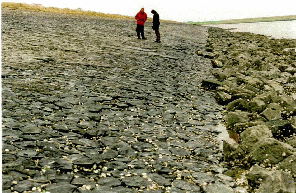
Foto 23 Bekleding 19201 bij km 19,4. Onderaan het talud is de penetratie minder aanwezig. Ook lijken hier wat zakkingen in het talud te zitten.
