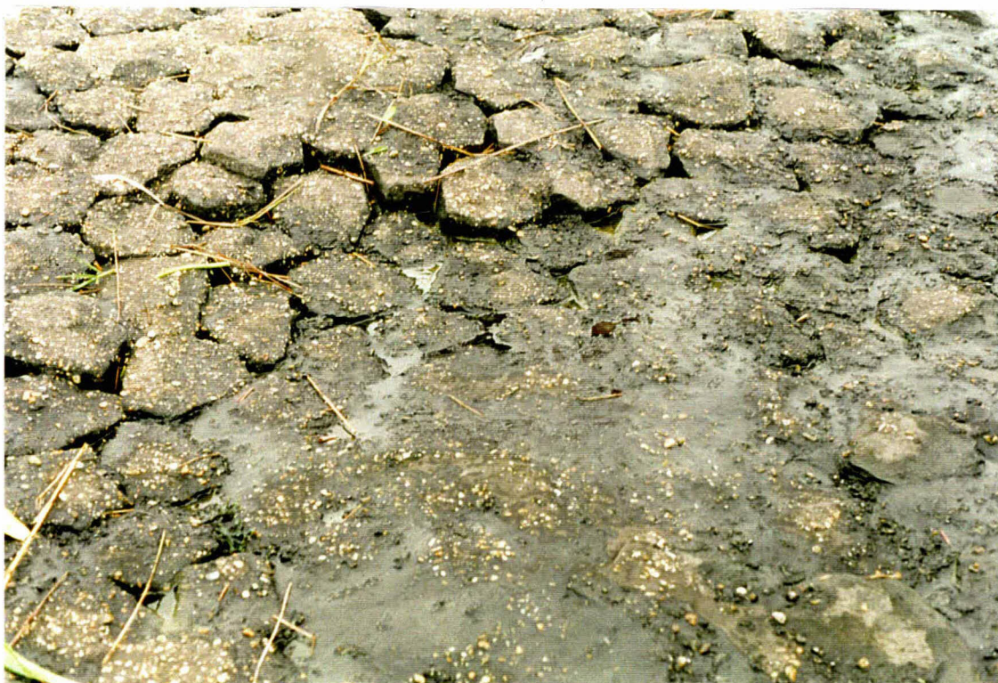
Foto 24 Bekleding 19201, km 19,3. Rond de hoogwaterlijn zitten enkele deuken in het talud.
