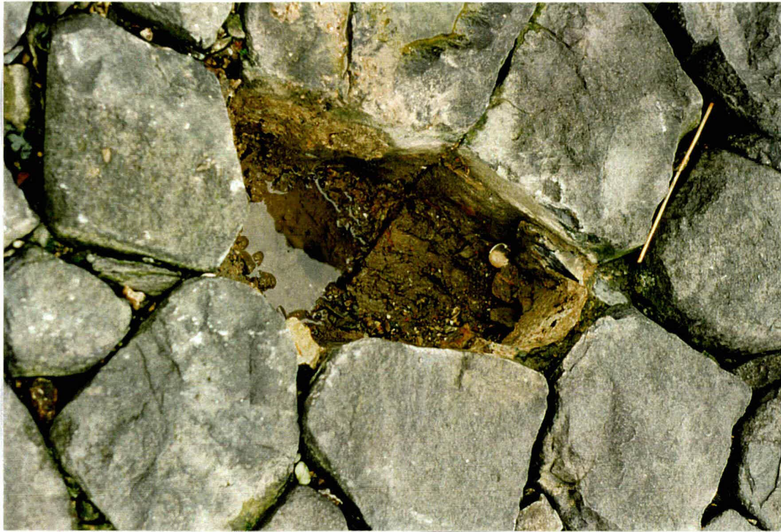
Foto 29 Gat in bekleding 18901 bij km 19. Er staat nog water in het gat op een hoogte van ongeveer NAP + 3 m. In de spleten is nog wel penetratie zichtbaar, aan de bovenzijde nauwelijks.
