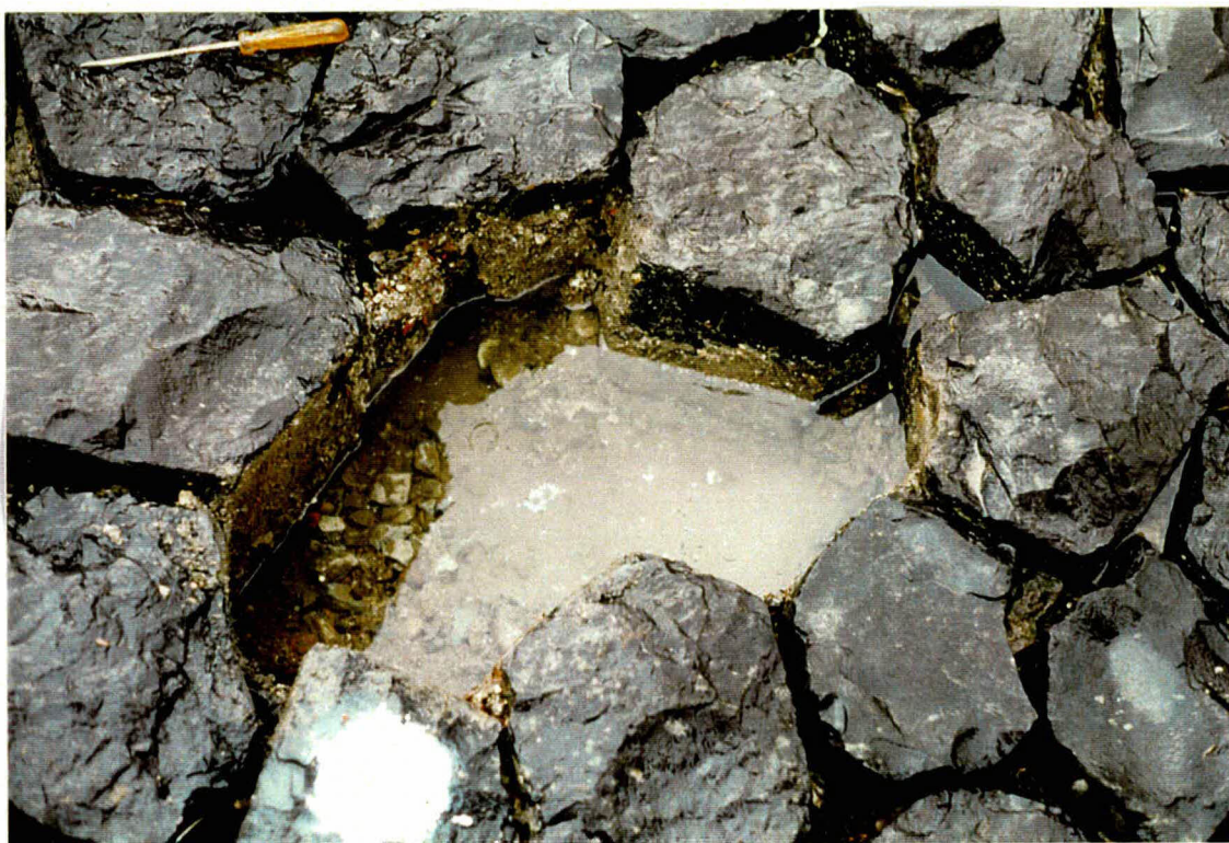
Foto 6 Gat in het basalt van vak 22302. De bekleding is helemaal dichtgeslibd.
