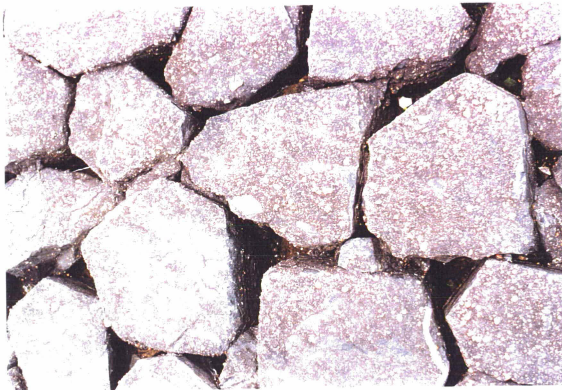
Foto 5 Bovenin het talud bij km 36.8 is nauwelijks penetratie zichtbaar.
