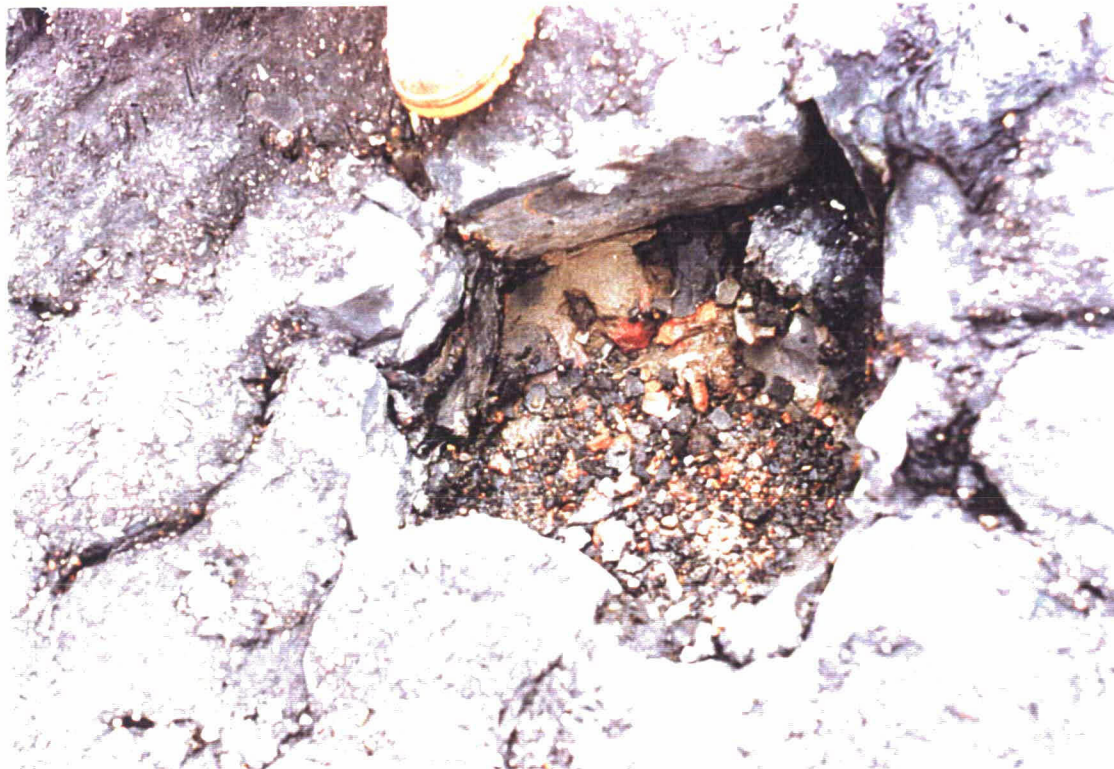
Foto 7 Gat bij km 36,875. Het filter is duidelijk ingezand.
