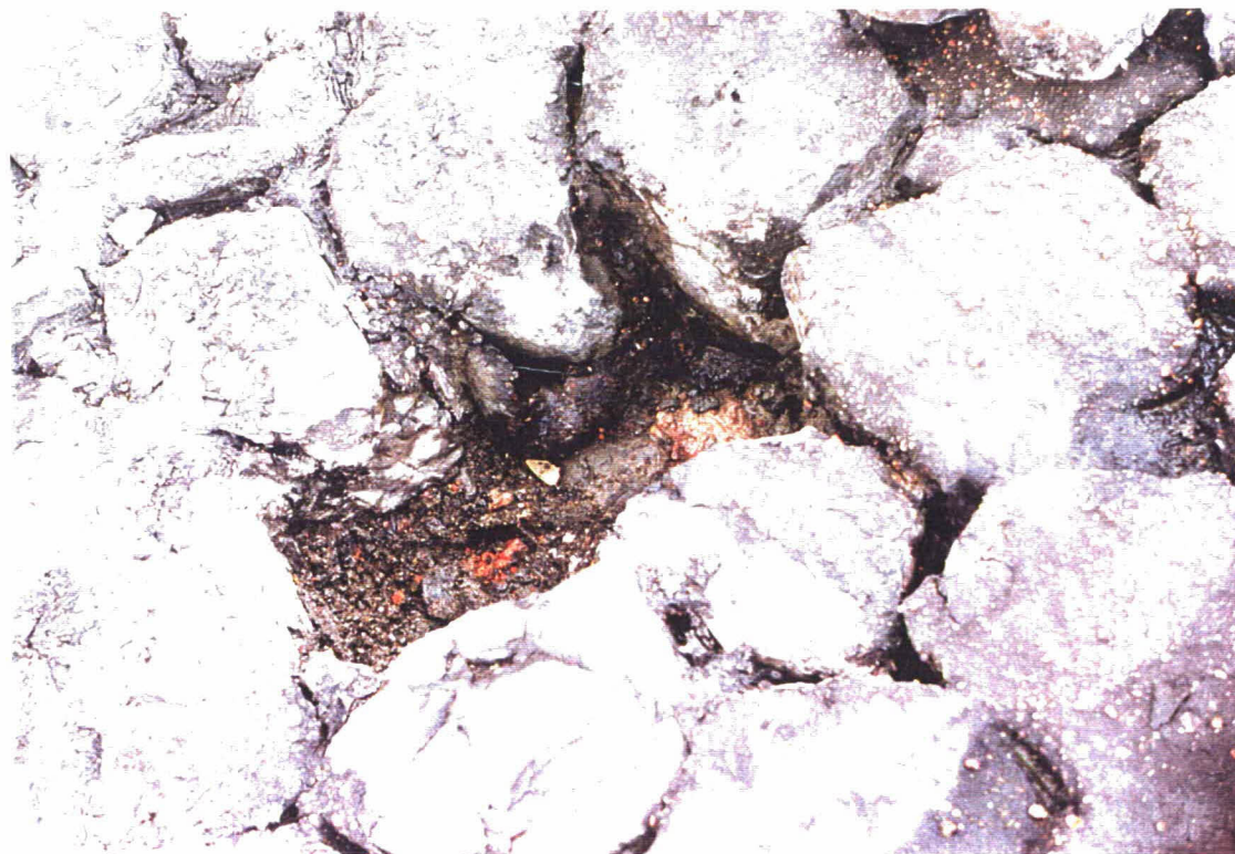
Foto 8 Gat bij km 37. Het filter is ingezand.
