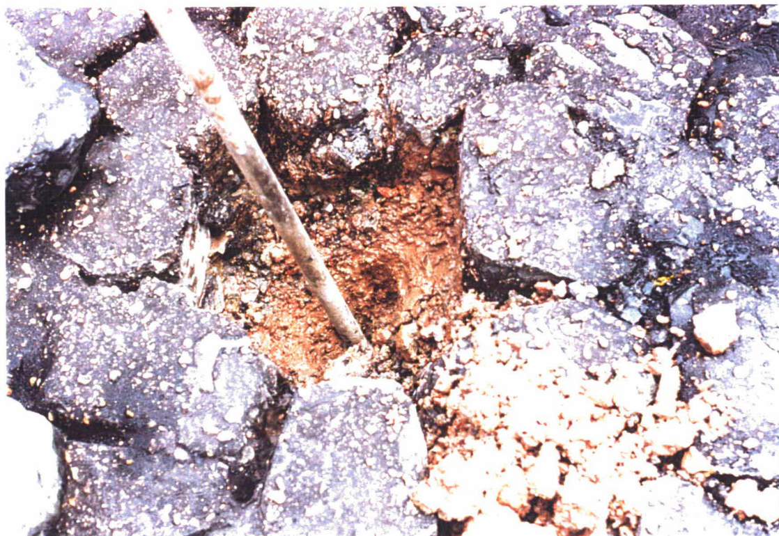
Foto 3 Gat bij km 36,75. Het filter is duidelijk ingezand.
