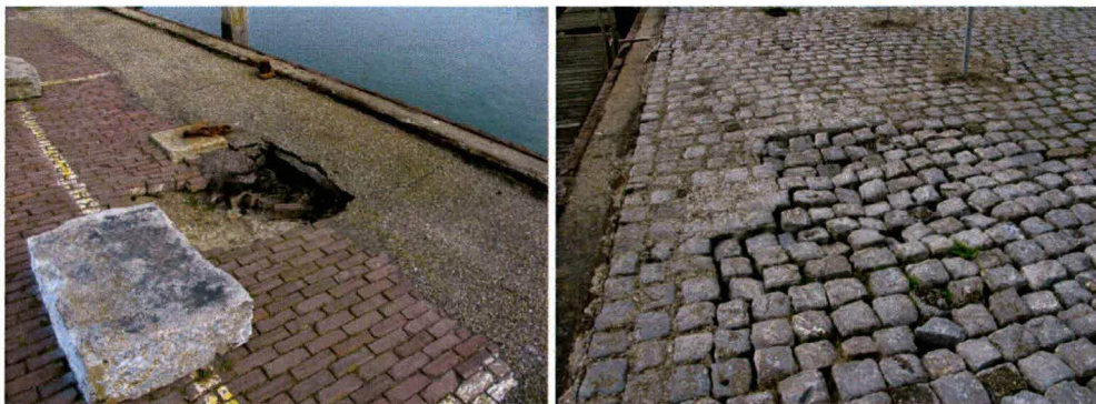
Figuur 2.5 Verzakkingen bestrating haventerrein
