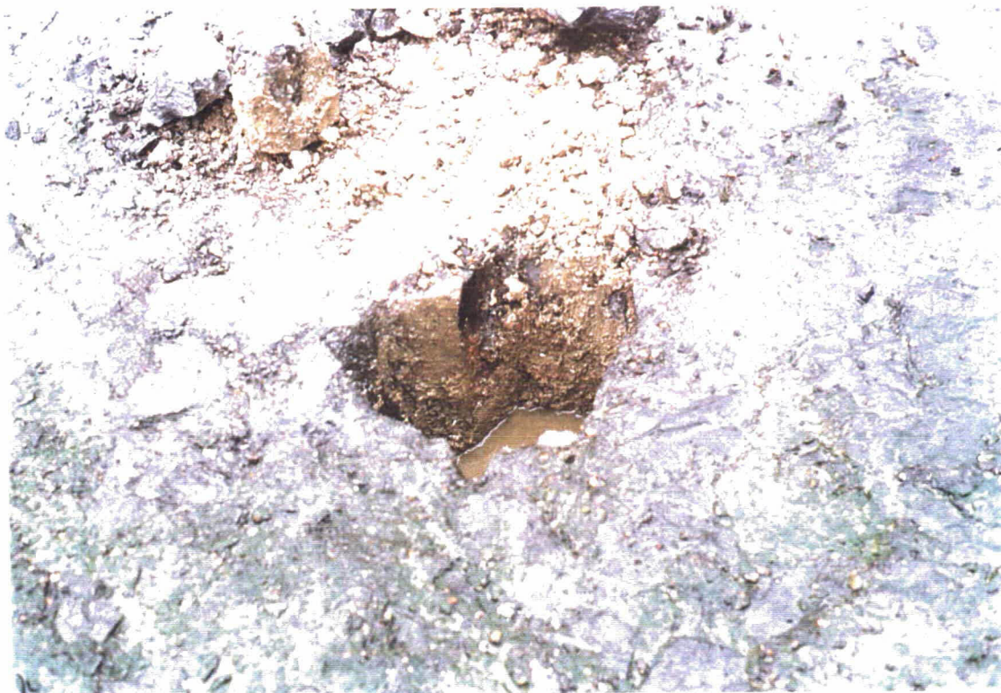
Foto 3 Gat bij km 30,75. Er is in ruime mate asfalt aanwezig, maar deze is niet al te diep tussen de spleten doorgedrongen. Het filter is duidelijk ingezand.
