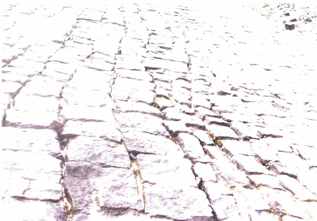
Foto 16 Bekleding 29801: met beton gepenetreerde granietblokken. Er is een afwisseling van grote en kleine blokken. Wellicht is een deel van de blokken staand geplaatst.
