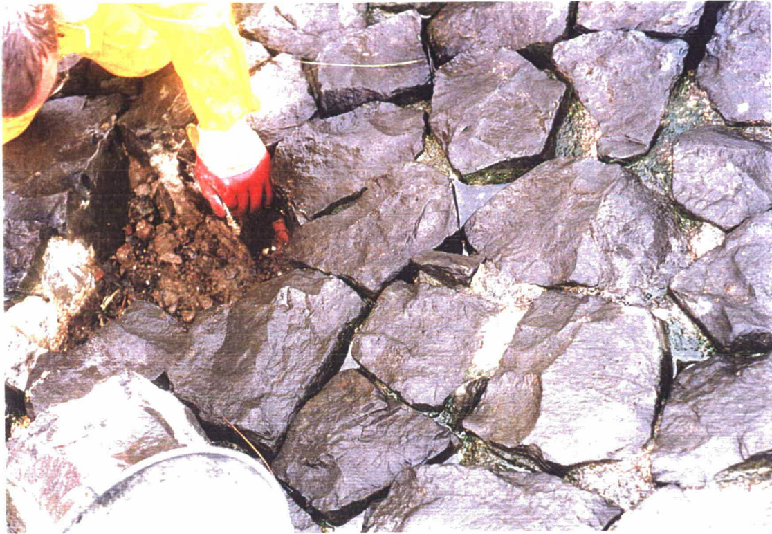
Foto 15 Gat in bekleding 29702. Het filter is dichtgeslibd, de penetratie lijkt deels uitgespoeld, maar rondom het gat is de penetratie redelijk.
