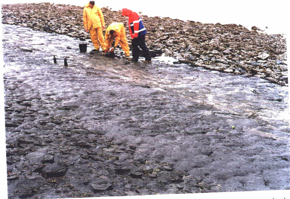
Foto 5 Gat laag in het talud in de ingegoten Doornikse blokken. Het voorland is vastgelegd met stortsteen
