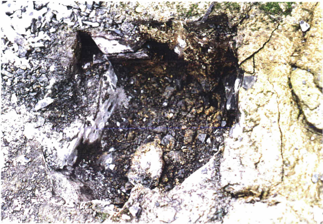
Foto 9 Gat in de gepenetreerde Doornikse steen bij dp 261.
