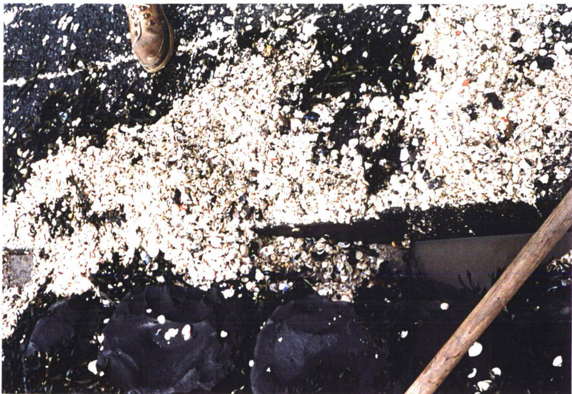
Foto 14 Er zit ruimte tussen de koperslakblokken laag op het talud en de basaltbekleding hierboven. De koperslakblokken zijn niet opgesloten, de basalt is tegen perkoenpalen gezet.
