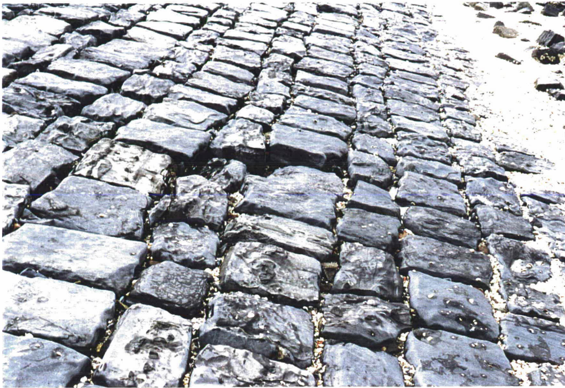
Foto 17 .Op een aantal plaatsen zitten slechte plekken in de bekleding. Deze foto is ongeveer bij dp 86 genomen. Er lijkt een halve steen te missen.
