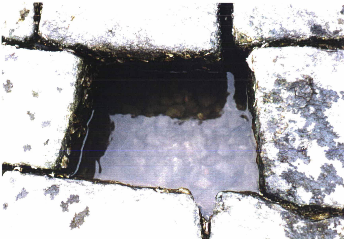
Foto 3 Gat in de bekleding als gevolg van een voorgaande inspectie (dp 259 + 50). Het steenslagfilter is schoongespoeld.
