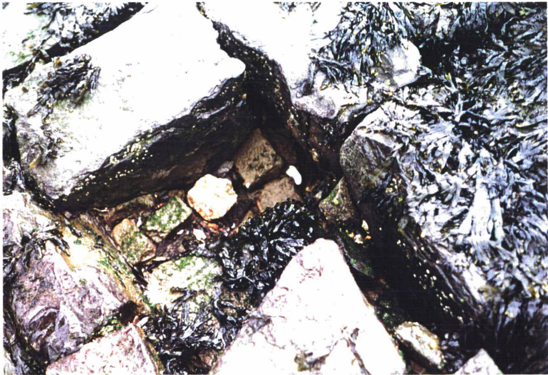
Foto 12 Doornikse steen verdwenen in het gedeelte Rijksdijk. Het puinfilter is goed zichtbaar.
