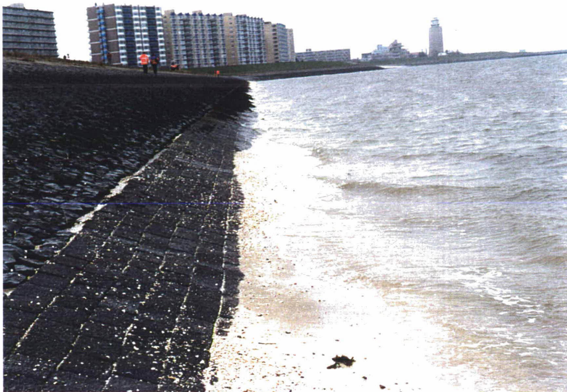
Foto 5: Overzicht van het westelijke deel van het vak. Foto genomen bij dp 91 in westelijke richting
