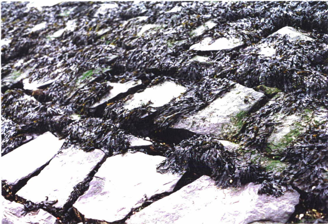
Foto 14 Het oppervlak van de bekleding is erg onregelmatig, er zitten grote gaten tussen sommige stenen en er is een rij blokken op zijn kant gezet.
