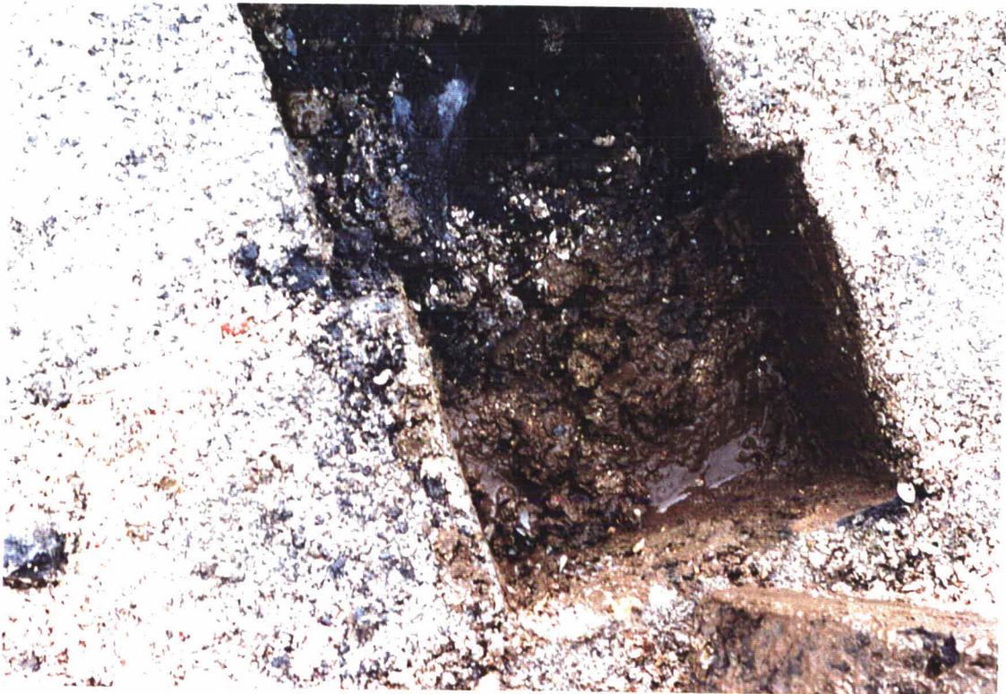
Foto 8 Gat in de koperslabblokken laag op het talud bij dp 94. Het filter bestaat uit steenslag dat volledig is dichtgeslibd.
