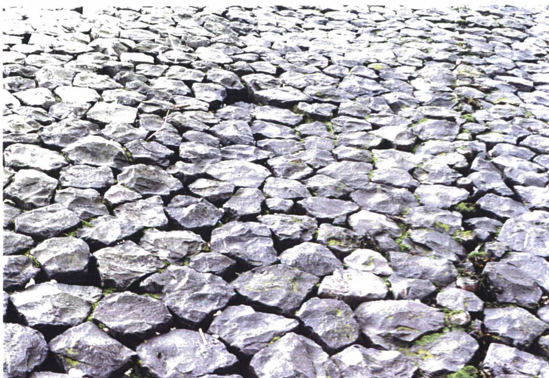
Foto 10 Verzakking in de basaltbekleding boven de perkoenpalenrij bij dp 91+50
