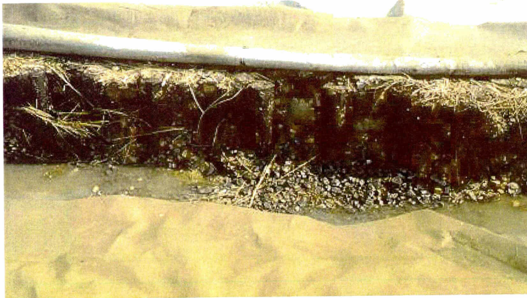
Detail van de granulaire laag ter plaatse van de infiltratiesloot na verwijderen van het geotextiel
