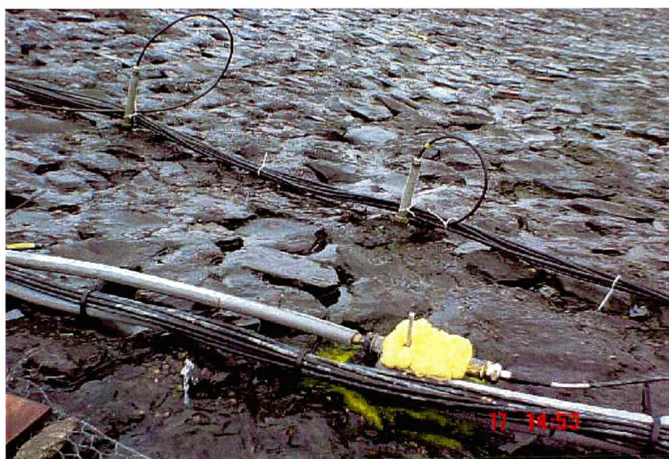
Detail meetraai, op de voorgrond de drukopnemers voor de verplaatsingsmeting, op de achtergrond de drukopnemers voor het meten van de druk onder de bekleding
