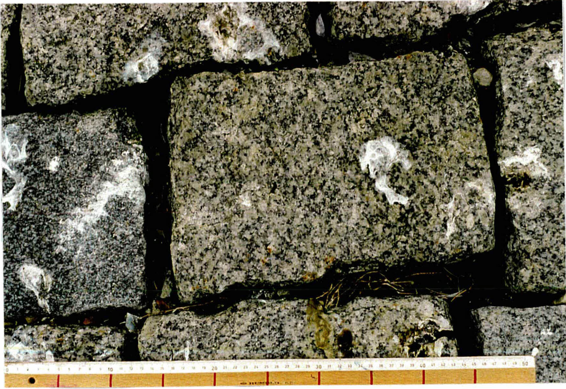
Foto 11 Spleten tussen de blokken bij dp 58.
