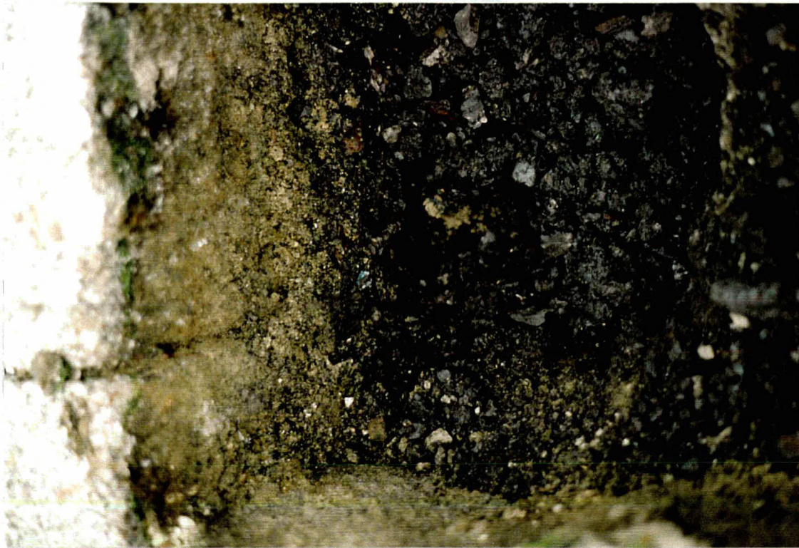
Foto 3 Gat in de bekleding (dp 69). De spleten tussen de granietblokken zijn dichtgeslibd.
