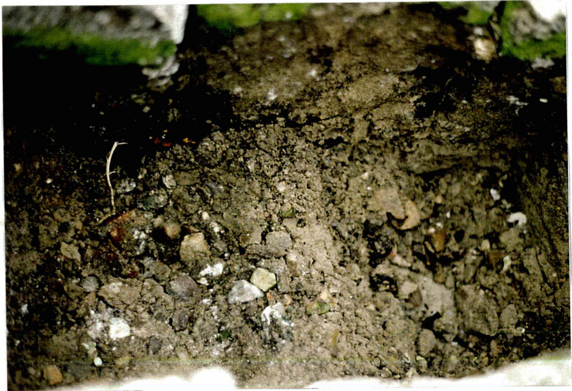
Foto 7 Gat in de bekleding bij dp 63.
