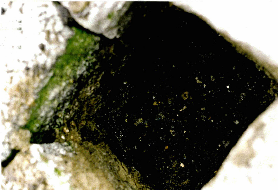
Foto 12 Gat in de bekleding bij dp 58.
