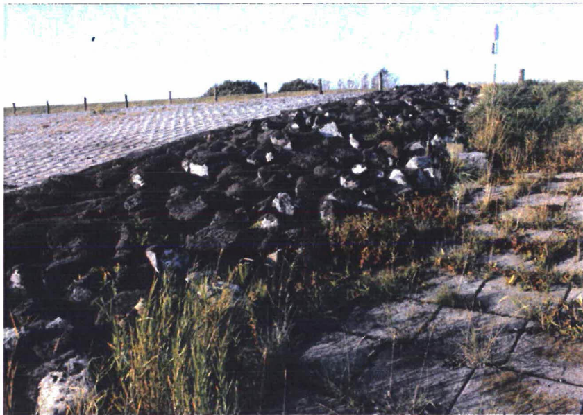
Figuur 2.3 Overgang reeds voltooide dijktraject Westelijke Sloehavendam (links) naar het te realiseren Schorerpolderdijk dijktraject (rechts).
