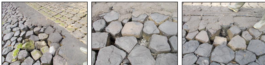
Foto's 1a, b en c: strook herzette basalt onder overgangsconstructie
