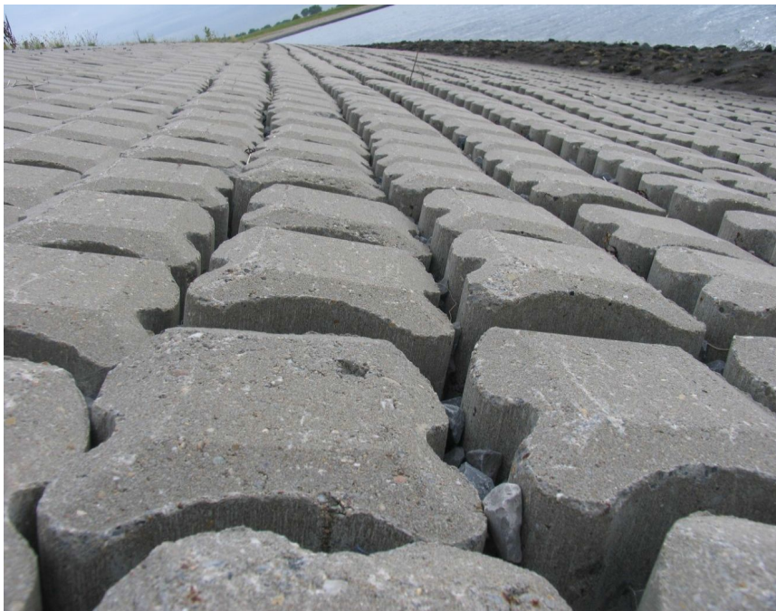
Figuur 1.1 Oneffen steenzetting bij de Poortvlietpolder ('kammende' zuilen)
