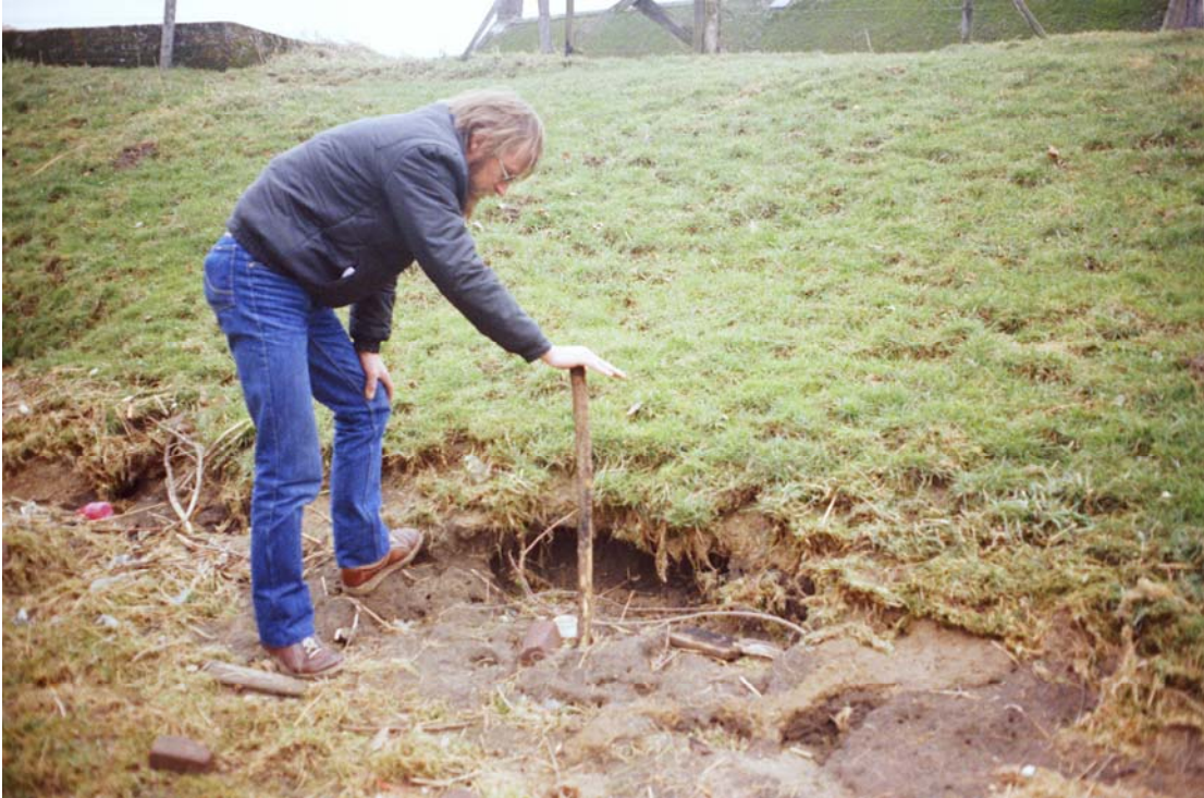
1.1a: Beschadiging van het buitentalud van een dijk door uitspoeling, mogelijk naar aanleiding van graverijen. [RWS-DWW 214/33a]
