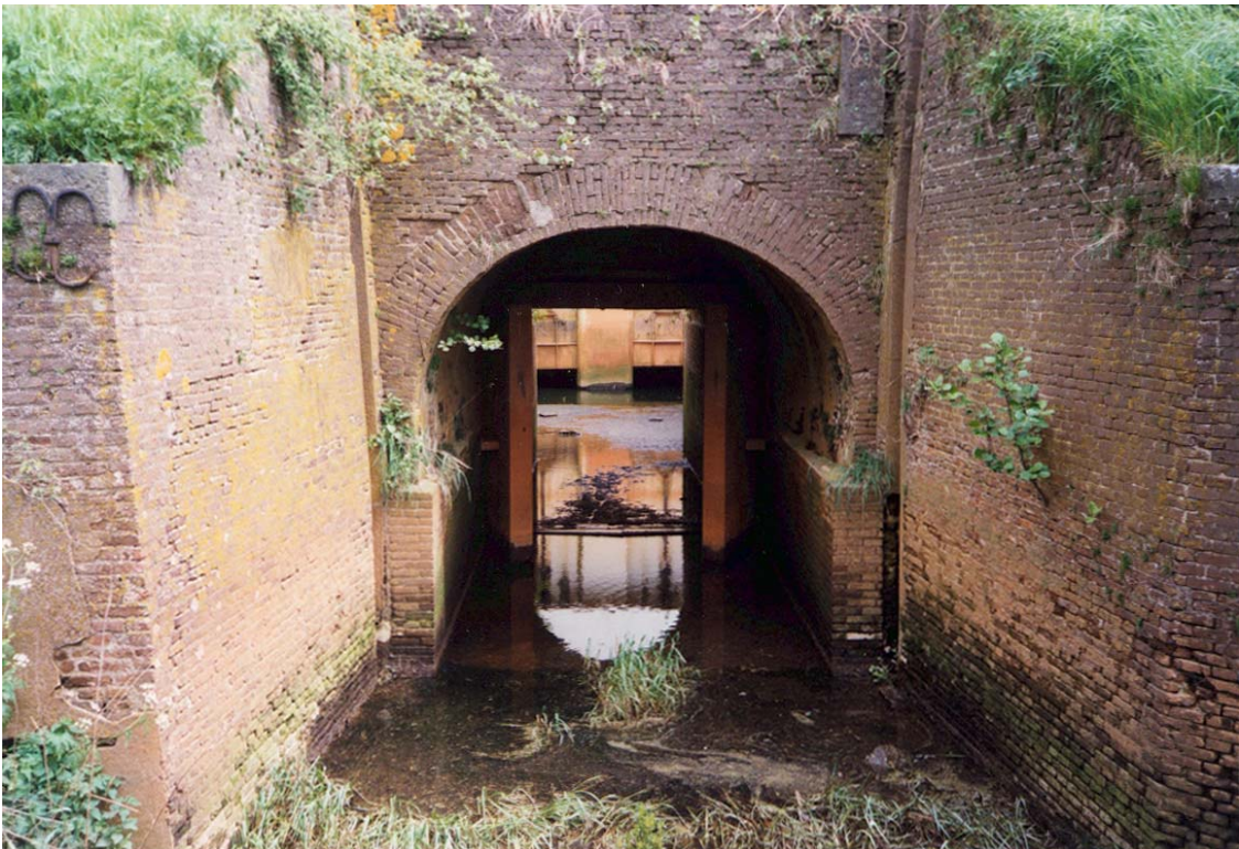
3.6d: Begroeiing uit vleugelwanden ter plaatse van instroomopening van een keersluis. Aan de waterdichtheid van de vleugelwanden kan worden getwijfeld. De ernst hiervan hangt af van de functie die de vleugelwanden moet vervullen t.a.v. piping. [Fugro].
