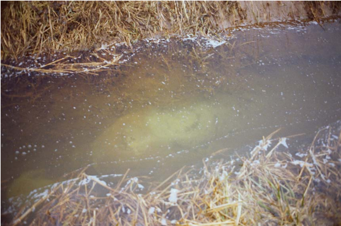
2.12c Zand in slotwater; beginnende zandmeevoerende wel ter plaatse van de bodem van een kwelsloot [RWS-DWW 127/12]
