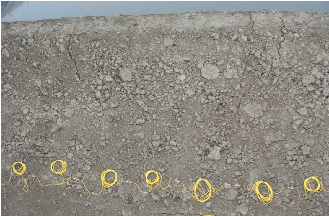
2.16a: Scheurvorming in dijkkruin bij IJkdijkproef [Deltares DSC0392]
