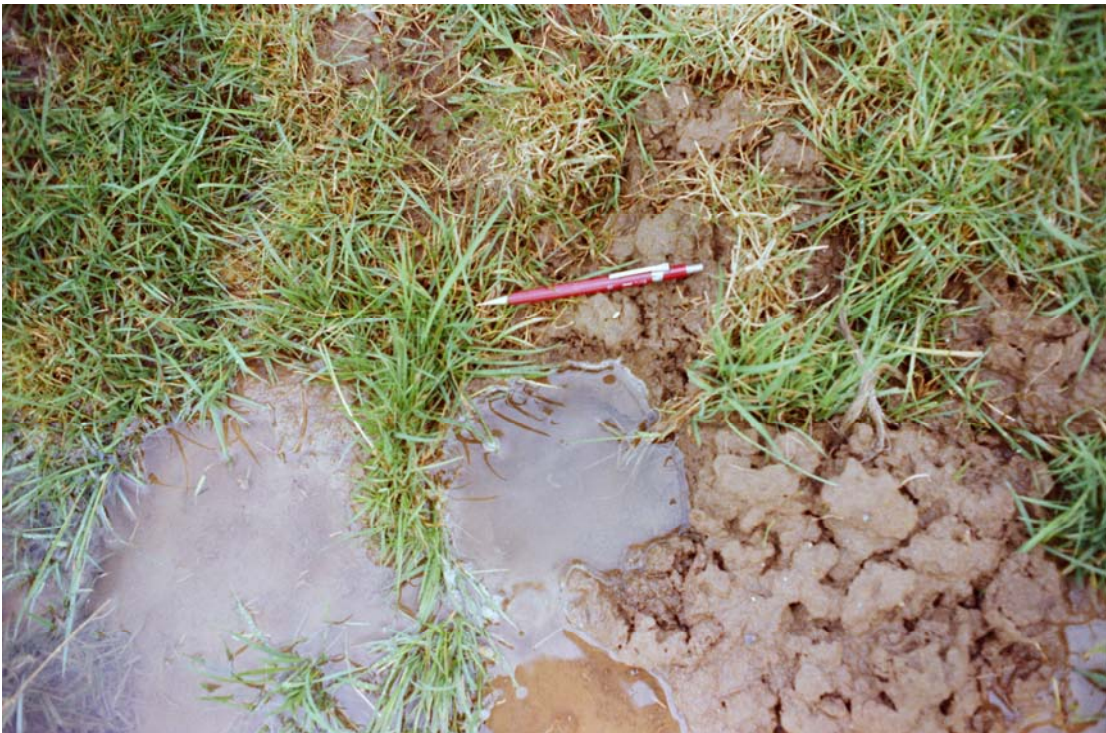
1.2a: Molshopen linker IJsseldijk te Wilp: is dit verzameld regenwater of al een teken van kwe! Van belang bij de beoordeling is de actuele weersgesteldheid en buitenwaterstand. [RWS/DWW 165/18a]
