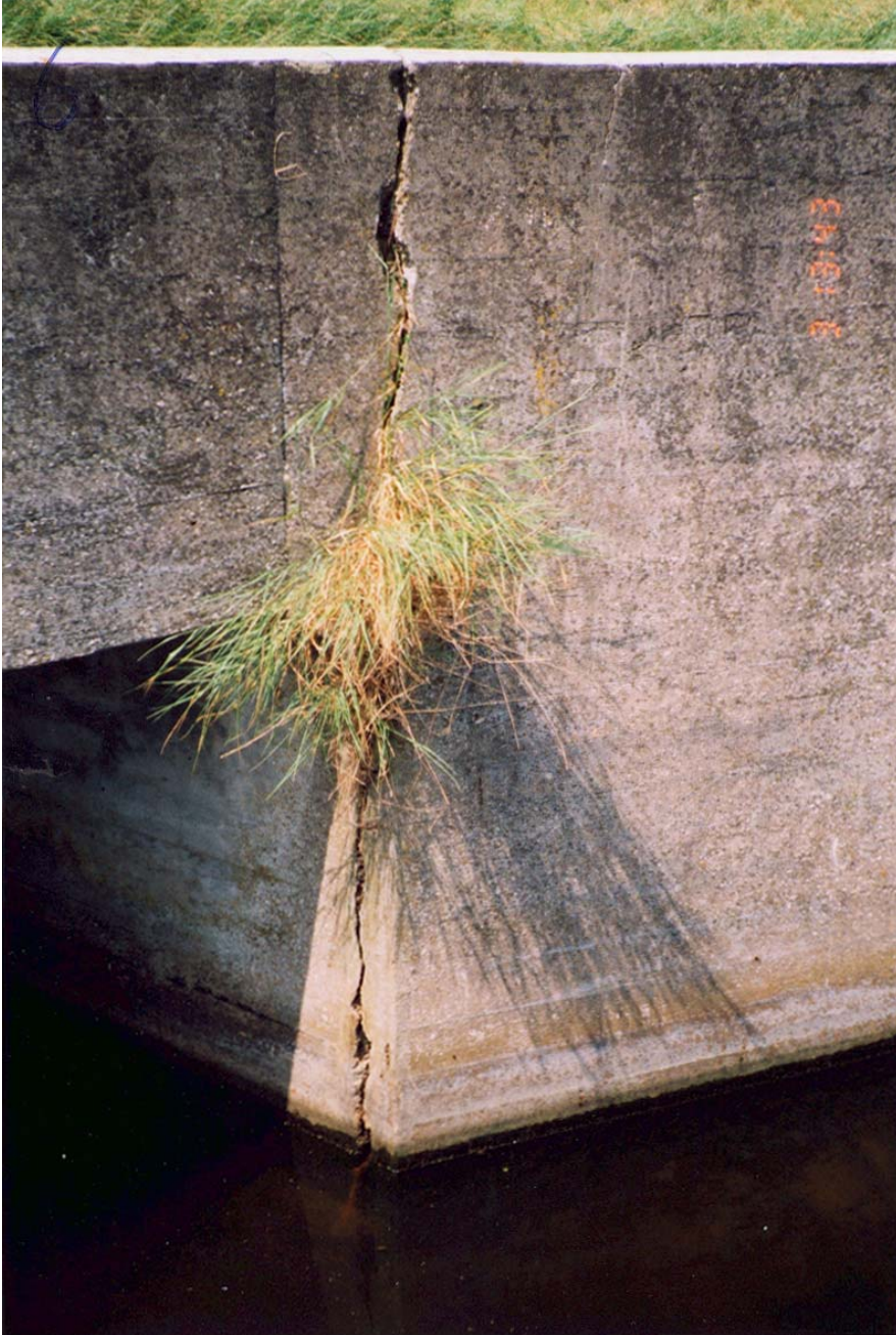
3.6e: Scheur met begroeiing bij de aansluiting van de koker op de frontmuur, aan de binnenzijde van een keersluis, Lummermerksluis in de oude Zuiderzeedijk nabij Elburg. [Fugro].
