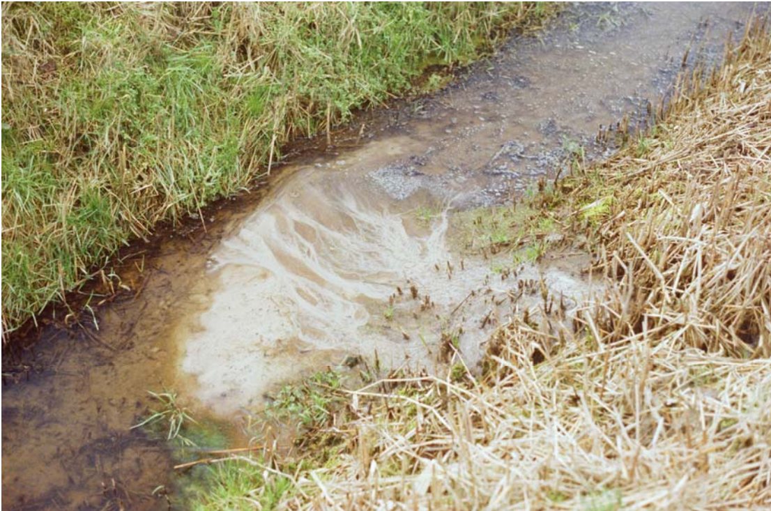
2.10: Zandmeevoerende wel in de sloot aan de teen van de Maasdijk te Lage Zwaluwe, in combinatie met een verzakt binnentalud. [RWS-DWW 128/22]
