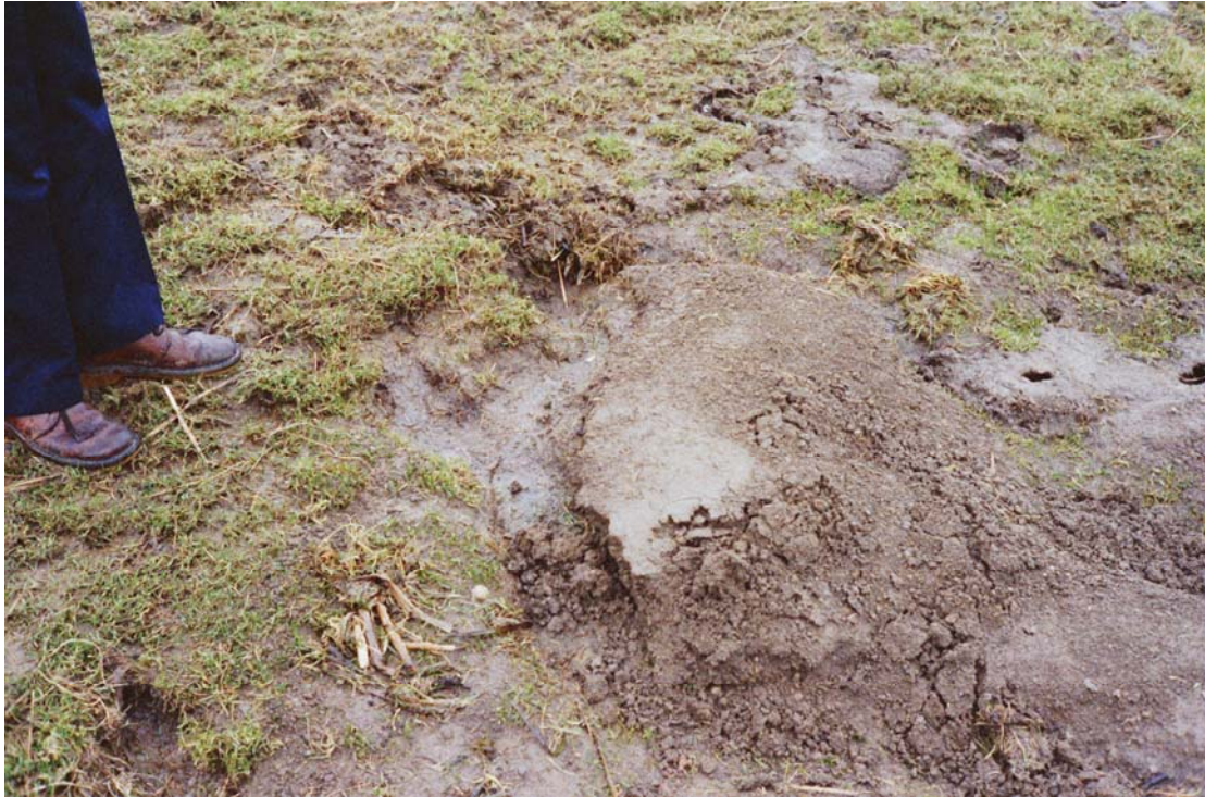
1.2d: Gangenselsel muskratten op het buitentalud. [RWS-DWW 220/27a]
