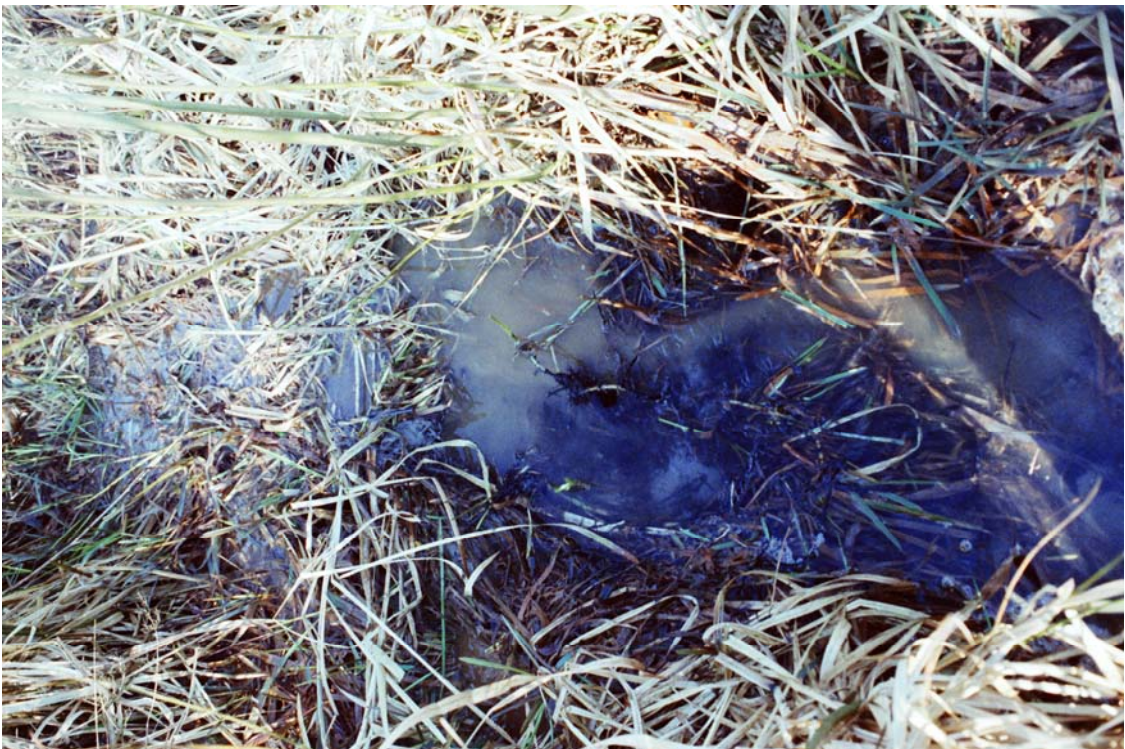
2.7: Wel uit de slootkant langs de teen van de Waalbandijk (hmp 348); er wordt nog geen zand meegevoerd. [RWS-DWW 132/9a]
