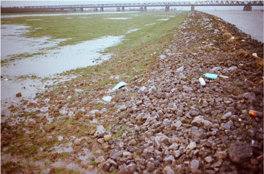
2.6: Water spoelt door een kade, plaatselijk t.p.v. een bocht. Van belang is dat van dichtbij gecontroleerd wordt of ter plaatse van deze natte plekken ook zand is uitgespoeld. [RWS-DWW 125/14]
