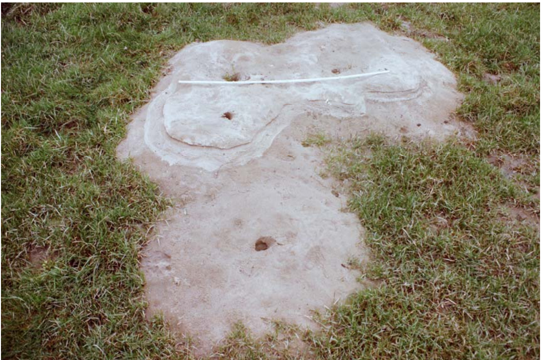
1.2 c: Droge wellen op de Hondsbroekse Plei (IJsselkop). Mogelijke aanleiding: mollengangen. Van belang is de aan de inspectie voorafgaande hoogwaterstand. [RWS-DWW 133/4]
