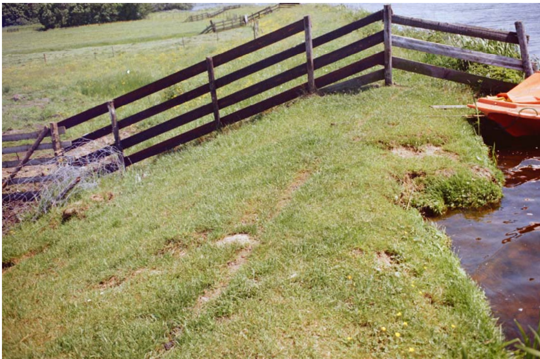
1.3 a: Afkalving van het buitentalud ter plaatse van een aardgasleiding, Kromme Does (boezemkade). [RWS-DWW 117/24a]
