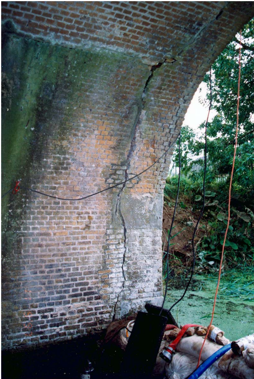
3.6b: Scheur in gemetselde kokerwand van een inlaatsluis, bij de uitstroomopening. De sluis is in verband met inspectie drooggezet. [Grontmij Bovensluis]
