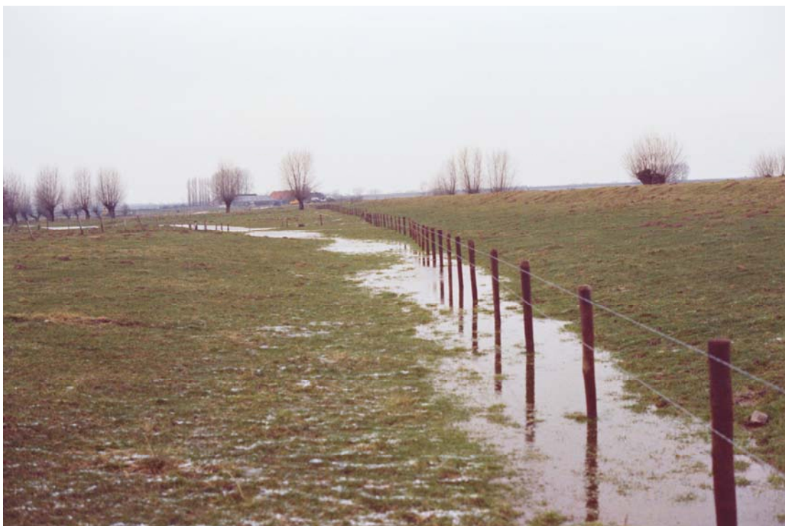
2.2a: Kwel langs palenrij aan de teen van het binnentalud van de IJsseldijk te Wilp Is dit begin van piping, mede ten gevolge van de palenrij, of is dit oppervlaktewater dat zich verzamelt op een laagste punt? [RWS-DWW 197/23a]
