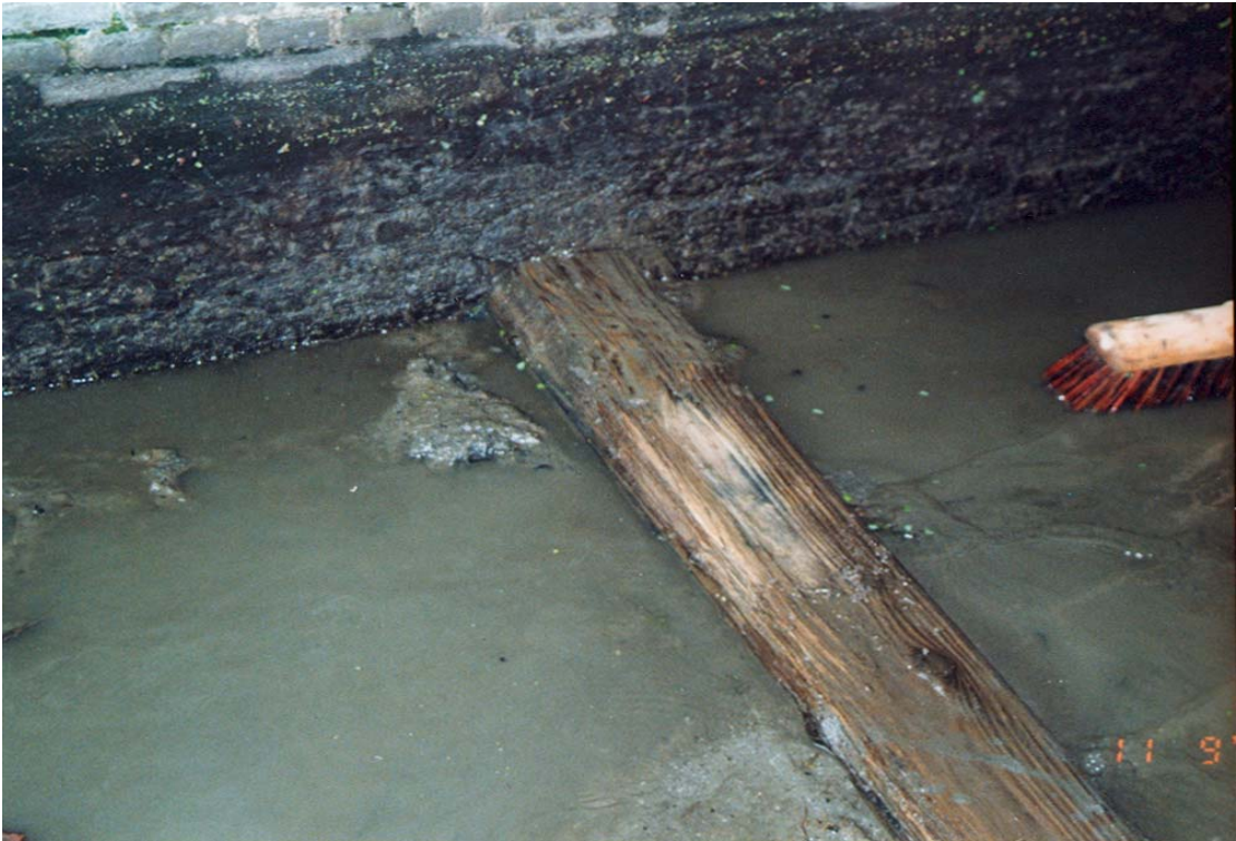
3.6c: Weggerotte houten vloerconstructie, inlaat Westbeer. De inlaat is in verband met inspectie drooggezet. Ondergrond bestaat uit klei, zodat dit geen gevolgen heeft te hebben met betrekking tot piping [Grontmij].
