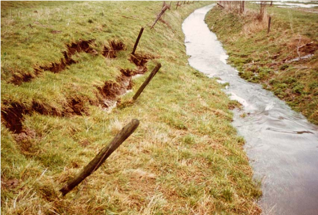
2.15a: Verzakken binnentalud Maasdijk nabij Balgoij. [RWS-DWW 331B_01]
