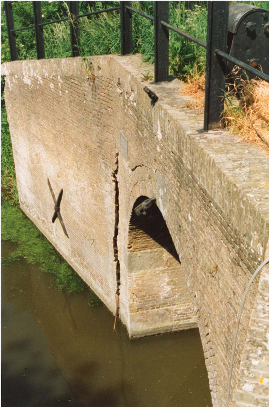
3.6a: Scheur bij aansluiting koker en frontmuur in een inlaatsluis, aan de binnenzijde. Dit kan aanleiding zijn voor achterloopsheid. [Grontmij Bovensluis 1.15]
