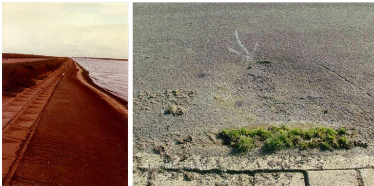
Figuur 9-11: Links: zakking als gevolg van zettingen van de ondergrond. Rechts: zakking als gevolg van uitspoeling, in dit geval via de onderste overgangsconstructie. Let ook op de verzakte blokken onder in beeld
