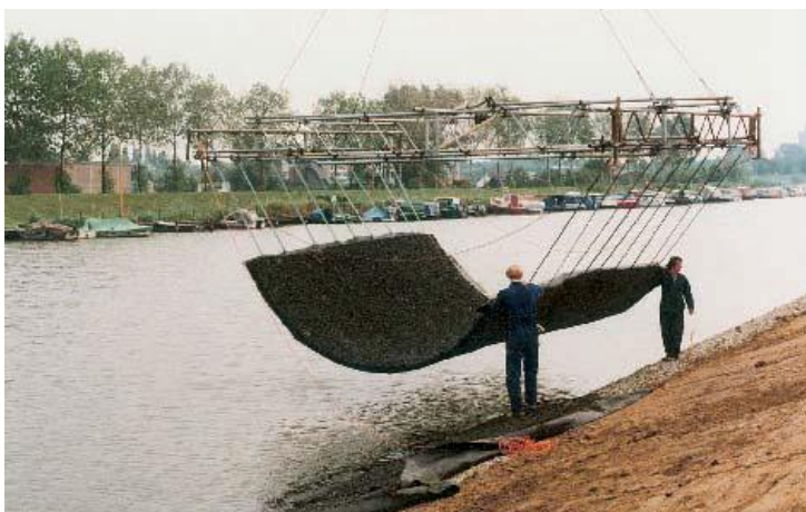
Figuur 8-23: Plaatsen van een mat van open steenasfalt met behulp van een hijsframe - Kanaal van Steenenhoek - 1982 (foto Bitumarin)
