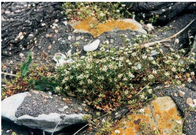
Figuur 3-17: Oude gietasfaltpenetratie met begroeiing - Grevelingendam – 1996
