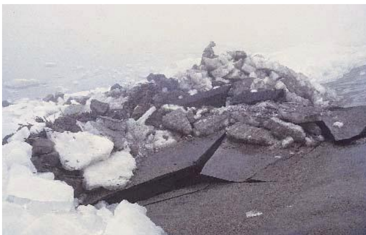
Figuur 4-24: Schade aan een asfaltbekleding door kruierend ijs – Houtribdijk
