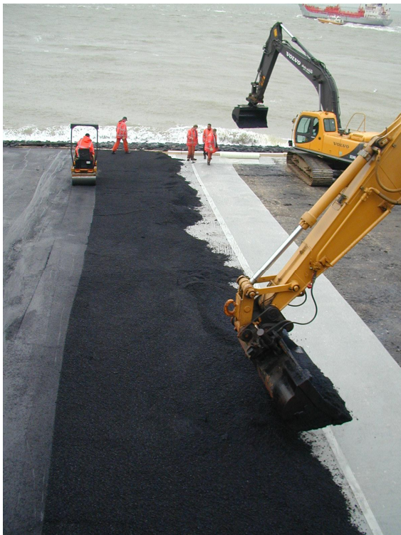
Figuur 4-49: Overlagen van een bekleding van waterbouwasfaltbeton op een wapening van glasvezelgrid op de boulevard de Ruijter in Vlissingen. In dit geval lag de oude bekleding van waterbouwasfaltbeton op een kleilaag. Bij het verwijderen van de oude bekleding zou tevens de kleilaag verwijderd moeten worden, omdat het aanleggen van waterbouwasfaltbeton op klei problematisch is; vochtige klei is te vervormbaar waardoor het verdichten van asfalt niet goed mogelijk is. Daarom is er bij de boulevard de Ruijter voor gekozen om de oude bekleding te laten liggen en een nieuwe laag waterbouwasfaltbeton aan te brengen met een wapening
