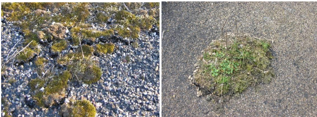
Figuur 9-12: Begroeiing op asfalt. Links: overgroeiing met mos. Rechts: kluit met begroeiing die los op bekleding ligt
