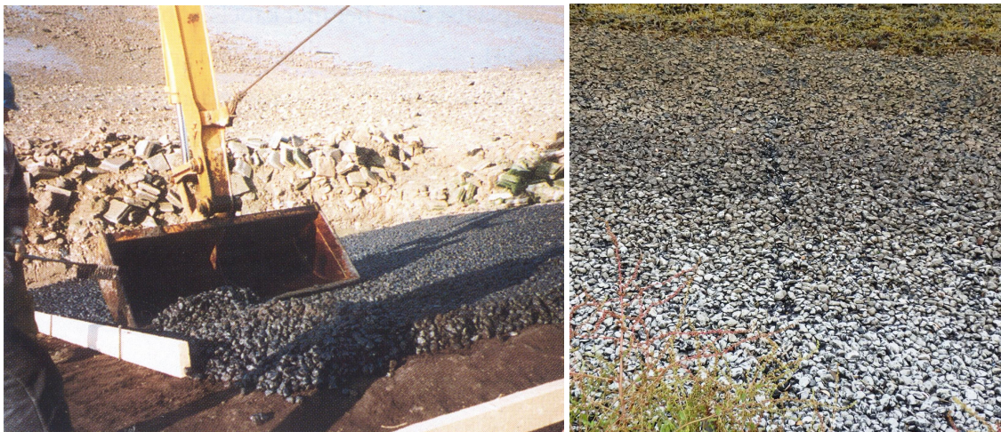
Figuur 8-22: Links: aanbrengen van een daglas van open steenasfalt op een filter van zandasfalt (foto Bitumarin); rechts: daglas in OSA na meer dan 20 jaar (foto Hydraphalt)
