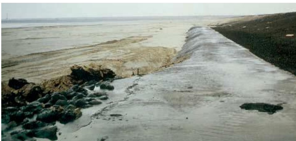
Figuur 4-23: Asphaltmastiesslab als bescherming van de teen van de dijk tegen ontgroning – Veersedam
