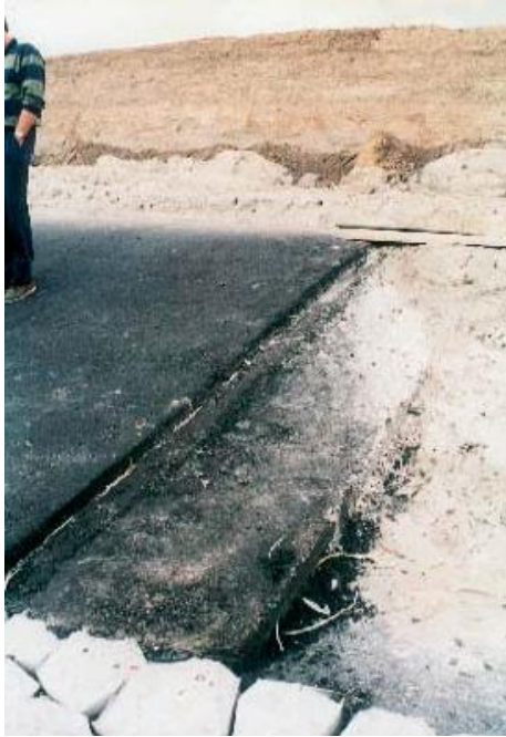
Figuur 8-17: Daglas in waterbouwasfaltbeton uitgevoerd als schuine liplas - Texel – 1998 (foto NPC)
