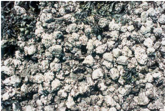
Figuur 11-5: Biologische aantasting van open steenasfalt door zeepokken - Neeltje Jans – 1989 (foto Oranjewoud)
