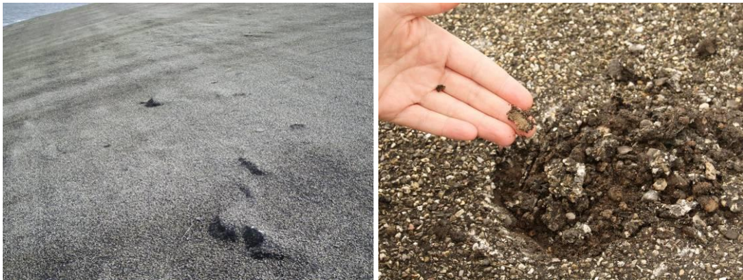
Figuur 9-8: Links: enkele zeer prominente opbollingen; rechts: open gebroken opbolling toont lokaal volledig uiteengevallen grindasfalt
