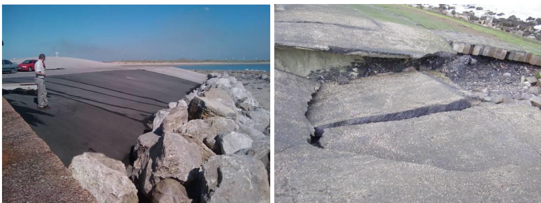
Figuur 9-4: Links: lokaal vervangen bekleding na schade door uitspoelen van zand bij een slecht uitgevoerde aansluiting op de betonnen constructie links. Rechts: gat na het instorten van de toplaag na ondermijning als gevolg van het bezwijken van de aangrenzende steenzetting
