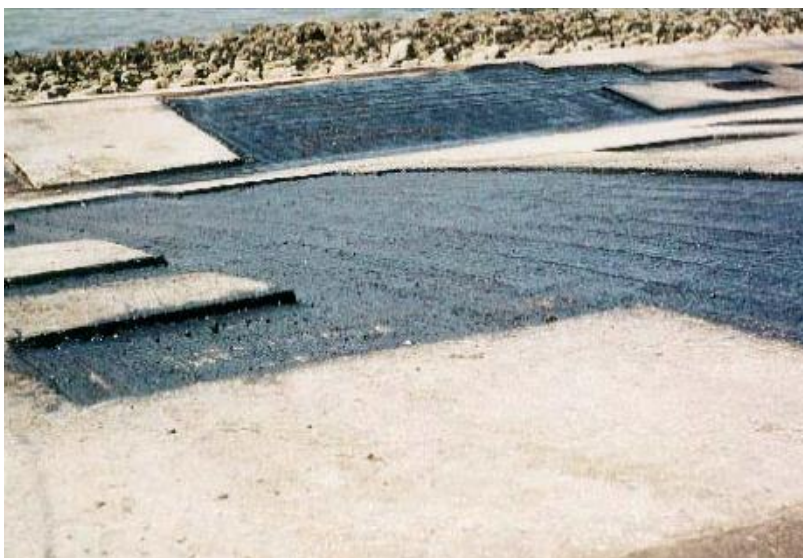
Figuur 10-12: Plaatselijk gefreesde bekleding - voor het uitvullen voorzien van een kleefmiddel - Roggeplaat – 1986
