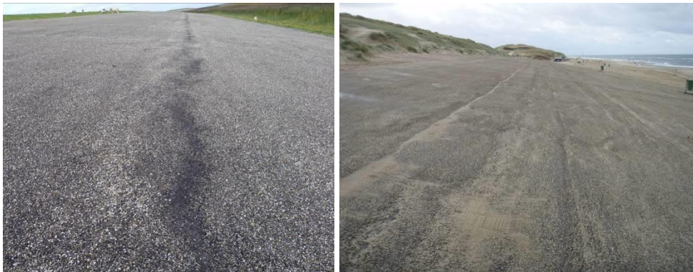
Figuur 9-9: Enkele strookvormige opbollingen
