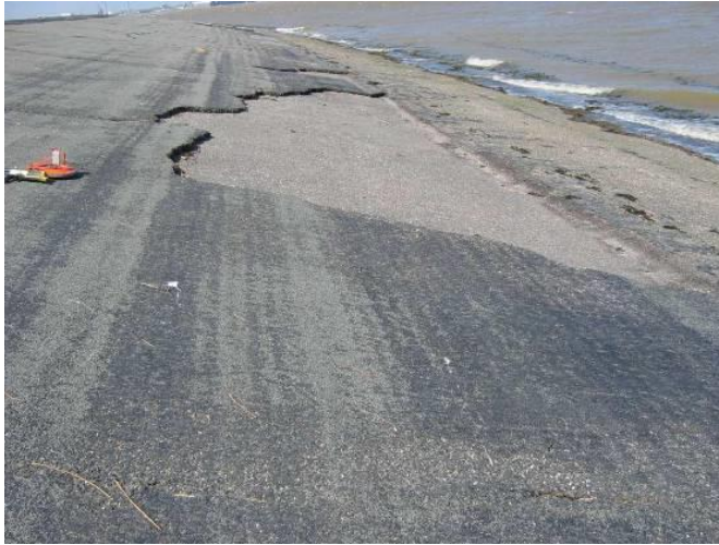
Figuur 9-17: Schade door loskomen later aangebrachte toplaag met onvoldoende hechting
