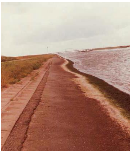
Figuur 3-9: Zetting van het dijklichaam op de plaats waar deze een oude watergang kruist - Schelde-Rijnkanaal – 1981
