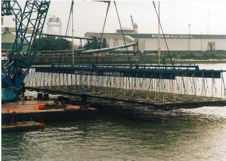
Figuur 8-24: Plaatsen van een grote mat van open steenasfalt met een hijsframe – Vulcaanhaven (foto Hydraphalt)
