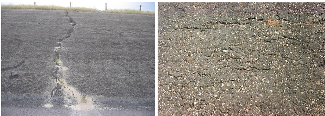
Figuur 9-1: Links: temperatuurscheuren waarbij zand van onder de bekleding is gekomen als gevolg van activiteit van mieren. Rechts: walscheuren
