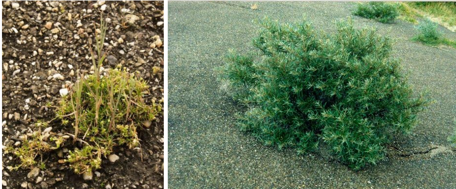
Figuur 9-13: Links: begroeiing in de bekleding (riet en spurrie). Rechts: begroeiing (duindoorn, struik) door de bekleding
