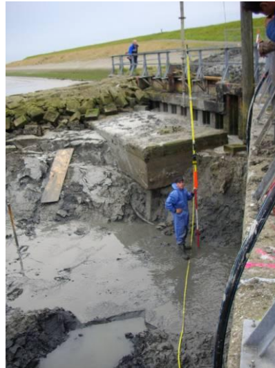
D: Overlopen van Vak 3 een dag na aanleg (3-november)
