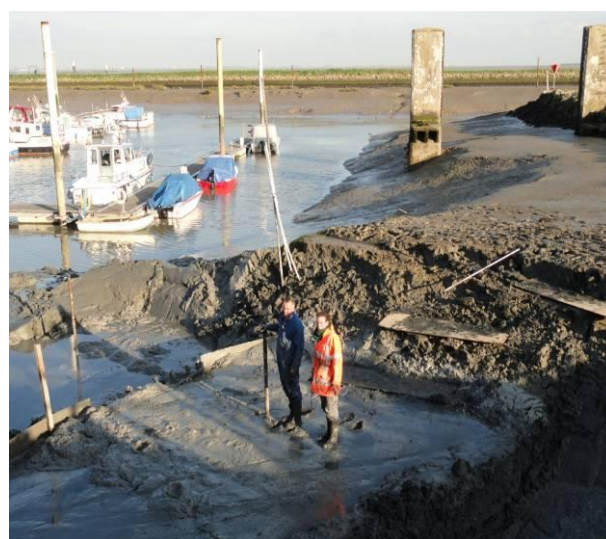
D: Overlopen van Vak 2 op 3-11-2011, circa 24 uur na aanleg. Zijkant van Vak 2 blijft staan bij ontgraven van Vak 3 (rechter hoek).
