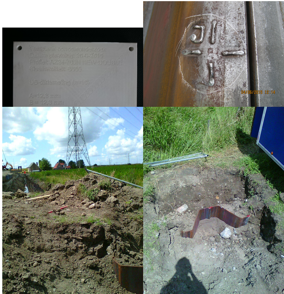
Afbeelding 4.3: Testplank Spui-West. Met de klok mee, vanaf linksboven: detail van de PETP-plaat met resultaat diktemetingen; aangebracht dradenkruis meetpunt J; de losse testplank na het slaan; de positie van de testplank ten opzichte van de damwand.
