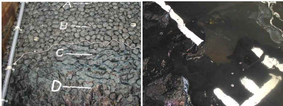
Figuur 2.22. Talud na P22 Links: scheur aangegeven met touw. Rechts: steen eruit.
