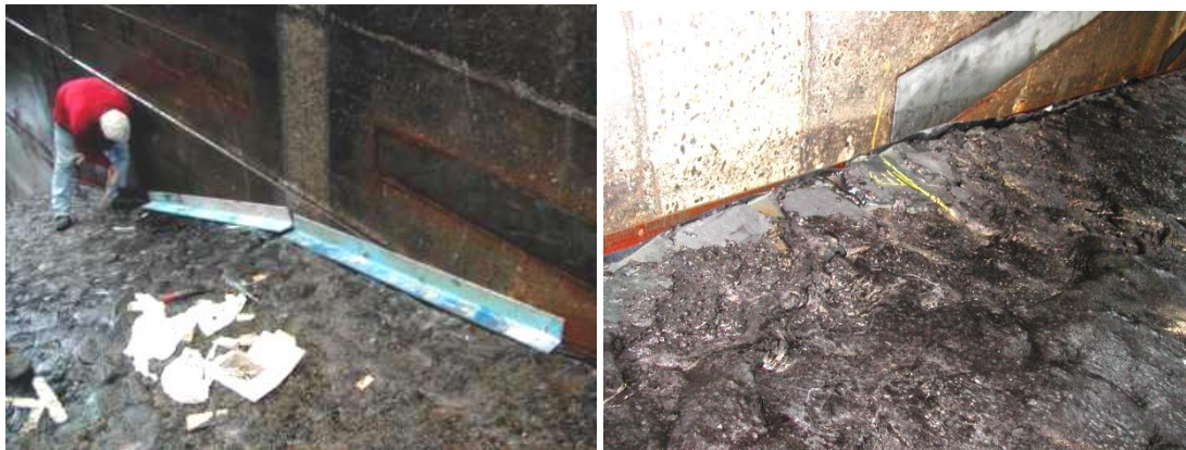
Figuur 2.18. Links: aanbrengen hoekprofiel rondom x = 10 m na proef P15. Rechts: Bolling aan oostwand van de goot bij markering E ( Z = 4,62 m), ontstaan na P16.
