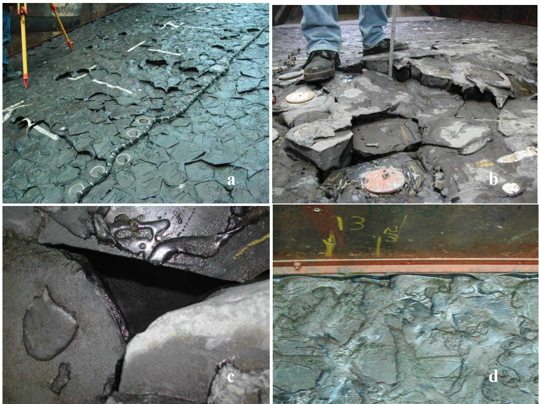
Figuur 2.14. Talud na proef P04. a: overzicht, b: bult bij J/K, c: bitumen en filtermateriaal weg bij I/J, d: spleet dicht bij J.
