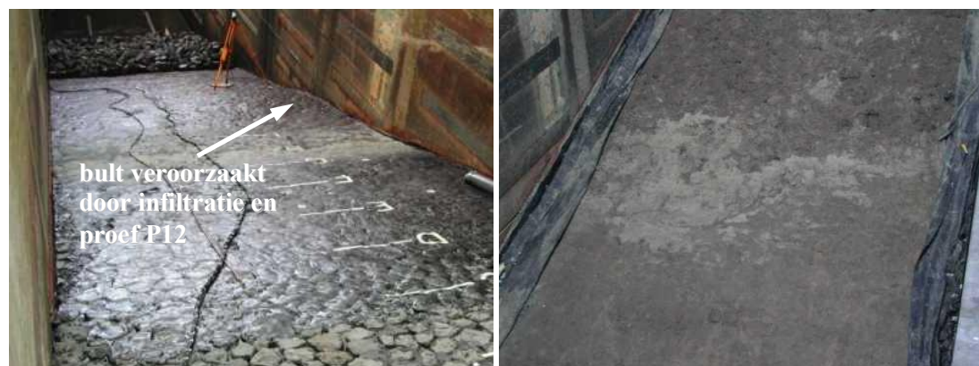
Figuur 2.16. Links: talud na P12. Rechts: zand op klei (en onder geotextiel) te zien na uitbreken tweede steenzetting.
