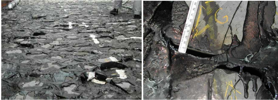
Figuur 2.13. Talud na proef P03. Links: overzicht, rechts: scheur bij F/G.
