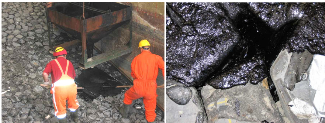
Figuur 2.6. De tweede ingegoten bekleding, gebruikt voor de proevenserie 2. Links: aanbrengen gietasfalt. Rechts: penetratie van de asfalt (foto's KOAC-NPC).
