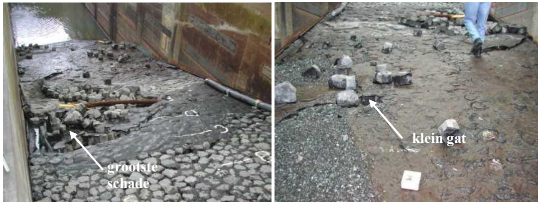
Figuur 2.23. Schade na P23a.
