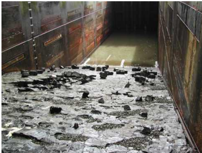
Figuur 2.15. Bezweken talud na proef P05.
