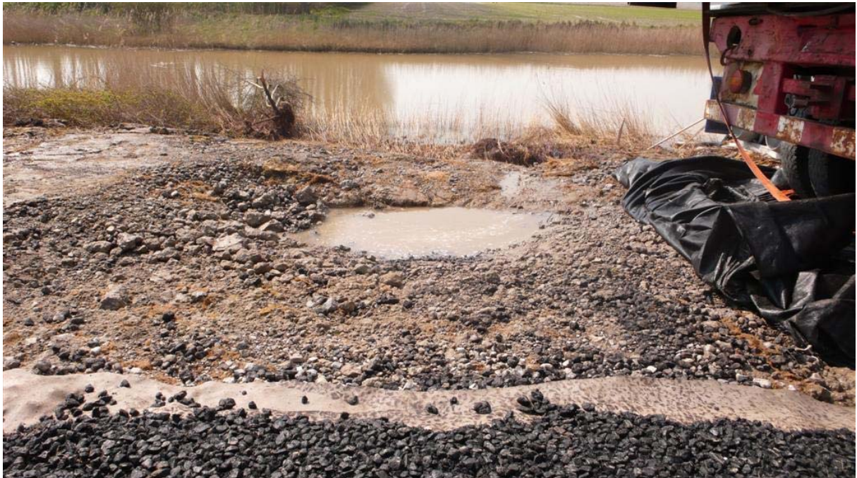
Foto F-20 Ondanks stevige maatregelen ter voorkoming van erosie van de onderhoudsweg waren getroffen was de onderhoudsweg licht beschadigd.
