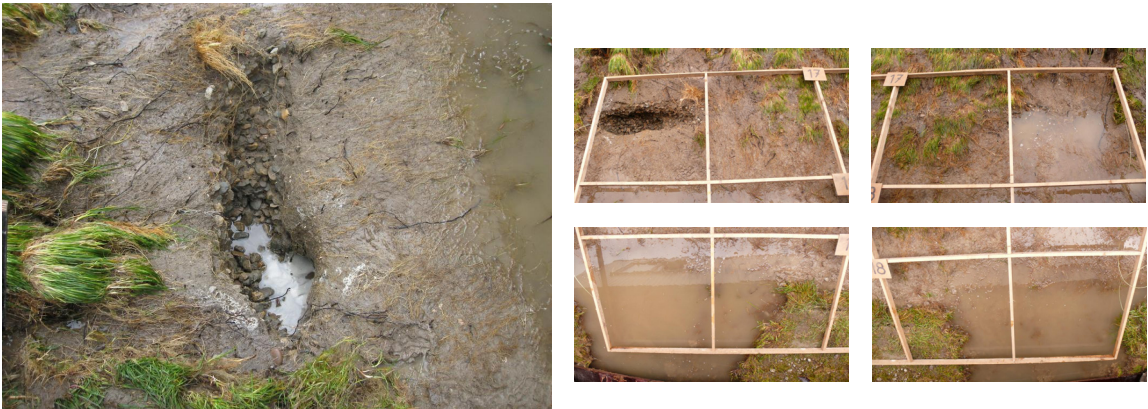
Figuur 9-4 De grindkoffer (links) en de ontstane schade ter plaatse van de door de mestinjecteur aangebrachte schade aan de teen van de dijk
