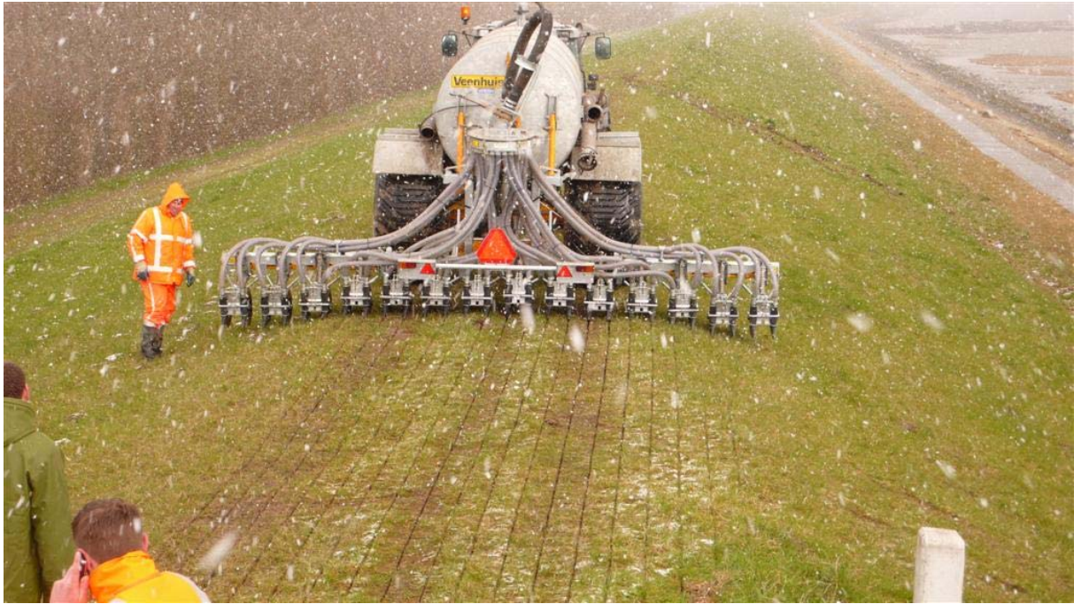
Foto F-13 Het aanbrengen van initiële schade op de kruin en teen van het talud met behulp van een mestinjecteur.
