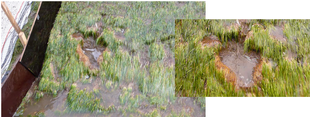
Figuur 9-1 Erosie linksonder op het talud
