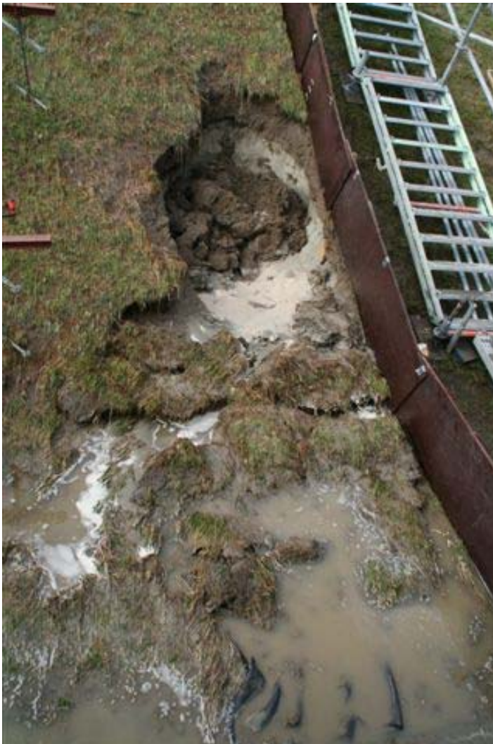
Figuur B16. Eindresultaat St Philipsland, na einde 50 l/s per m proef. Er was een gat in het horizontale gedeelte (de teen) van de dijk ontstaan, rechtsonder op de foto. Het gat op het talud was gegroeid en tenslotte heeft een grote golf het tussenliggende gedeelte naar beneden gedrukt. Duidelijk is de overgang klei/zand te zien en dat een diep gat in de zandkern is ontstaan.
