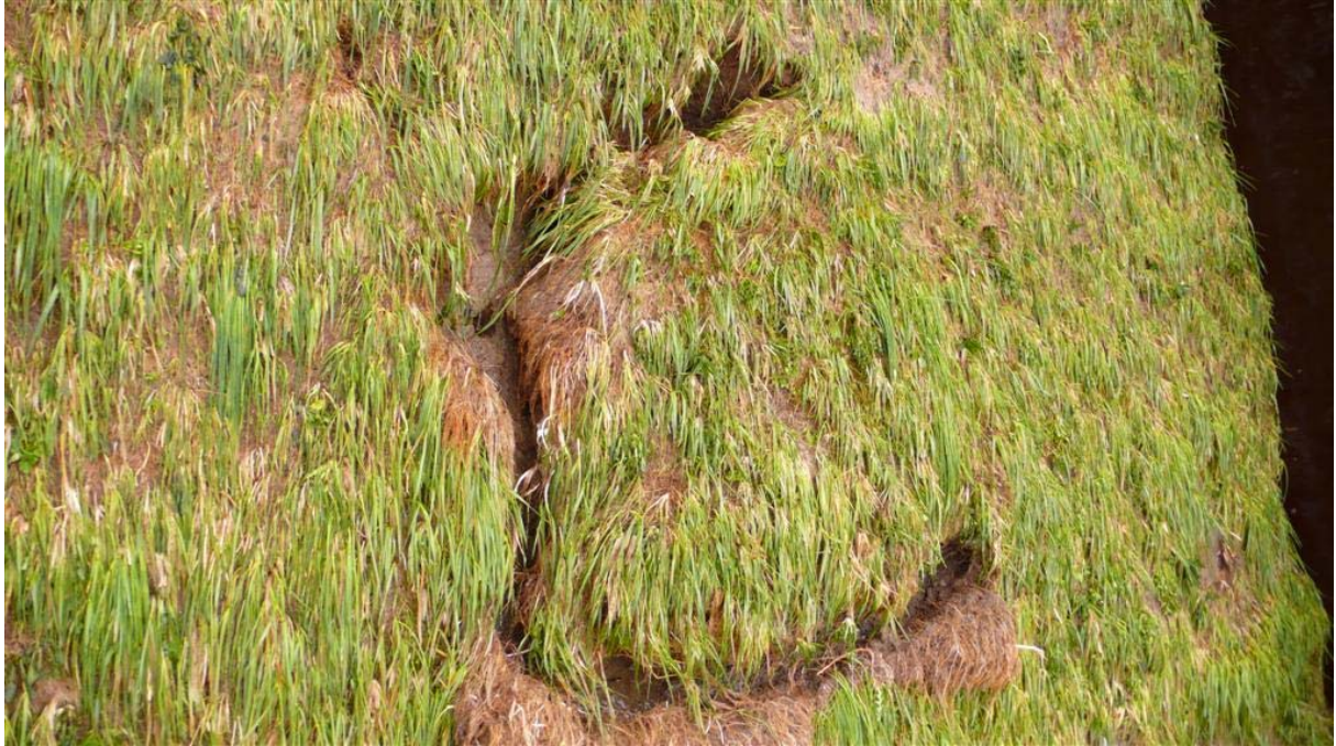
Foto F-16 Ondanks het feit dat klei onder de moot erodeerde, zat de moot voldoende vast om er niet door de golven uitgeslagen te worden. De moot zakte uiteindelijk na erosie van de klei weer langzaam in en stroomde het water weer over het talud zonder verder schade te veroorzaken.
