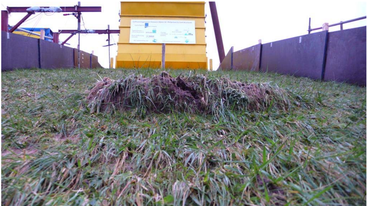
Foto F-15 Aan het begin van de tweede twee uur van de proef met 50 l/s per m sloeg de laagste paal, die verticaal in het midden van het talud was geslagen, eruit. Hierbij werd een moot klei met bekleding iets naar beneden en omhoog gedrukt
