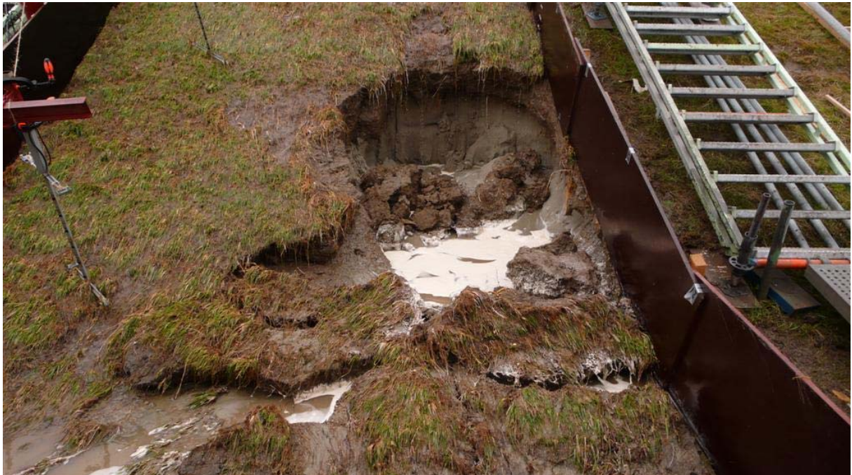
Foto F-6 Omdat inmiddels rechts in de teen van de dijk een gat zich in de richting van de overgang (talud – teen) heeft kunnen uitbreiden, werd het tussenliggende gedeelte tussen beide gaten, bij een van de laatste grote golven, naar beneden gedrukt. Besloten is om de proef te stoppen en de proef met 75 l/s per m niet meer uit te voeren.
