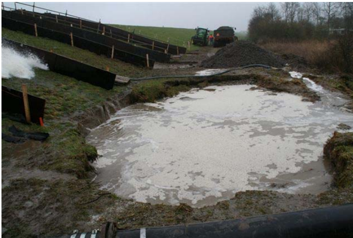
Figuur B20. Kattendijke, sectie 1. Uitbreiding van het gat op de onderhoudsweg, halverwege 75 l/s per m. Het gat werd uiteindelijk 15 m breed en ongeveer 1 m diep.
