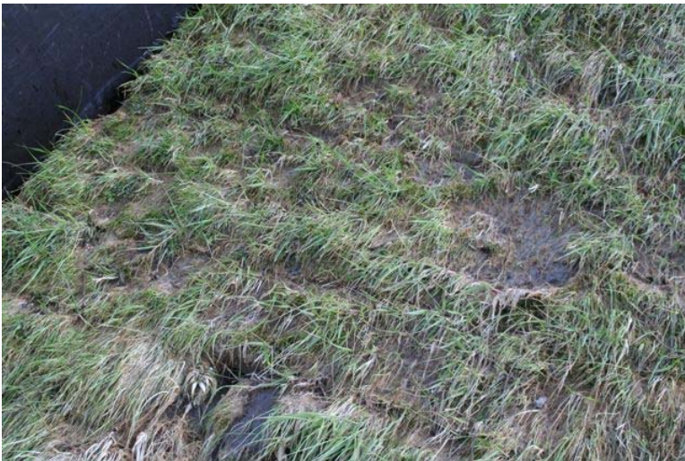
Figuur B23. Eindresultaat Kattendijke; sectie 2, na 50 l/s per m. Beschadiging door gierinjecteur geeft geen aanleiding tot schade. Verder geen schade aan talud zelf.
