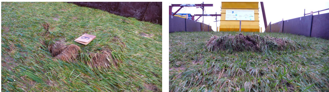
Figuur 9-2 Initiële schade als gevolg van het eruit slaan van een verticaal in het talud geslagen paal
