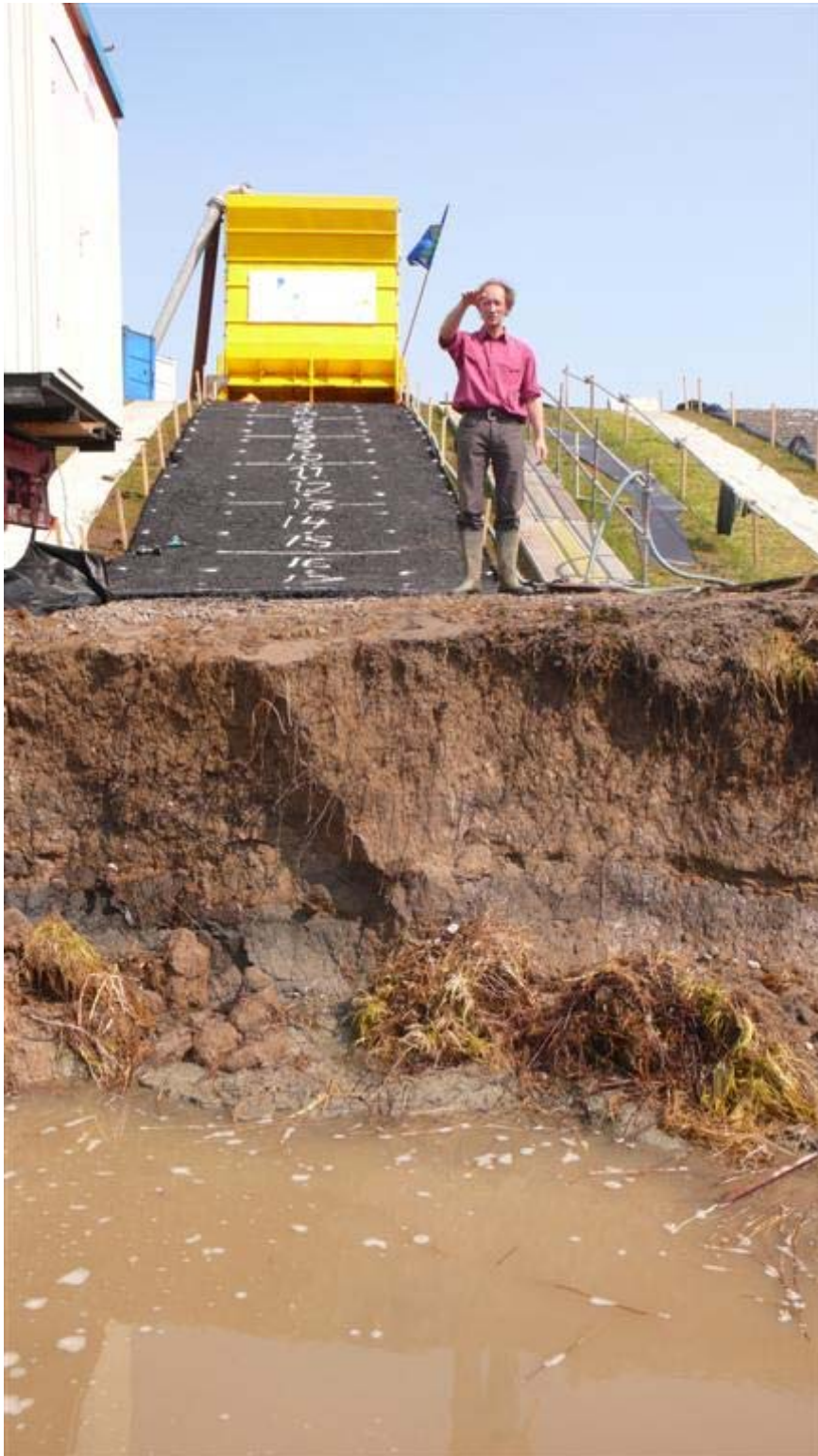
Foto F-21 In tegenstelling tot de schade aan de onderhoudsweg was als gevolg van de grote overslagdebieten een groot gat ontstaan achter de onderhoudsweg.
