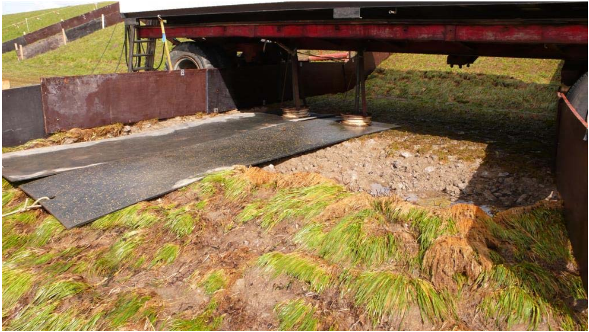
Foto F-8 Gedurende de proeven met 30 l/s per m ontstonden er erosiegaten op het horizontale vlak ter plaatse van de overgang talud – teen. Ook achter de onderhoudsweg (mijnsteen op een met zand opgevuld cunet) ontstond schade.
