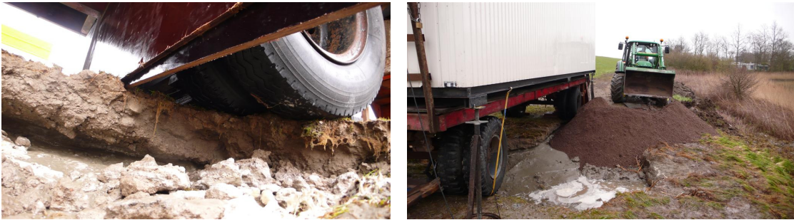
Figuur 8-3 Ondermijning van de platte wagen (links) en herstel van de schade (rechts)
