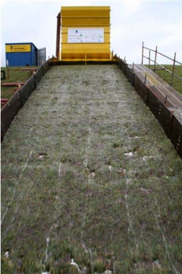
Figuur B17. Kattendijke, sectie 1, begin proef met 10 l/s per m. Matige bedekking met gras. In de hele sectie zaten ongeveer 80 molshopen en in het begin van de proef zijn de molshopen zelf weggespoeld, zodat de gaten/ingangen zichtbaar werden en soms ook de gangen als deze aan de oppervlakte lagen. Bij het begin van de proef werd ingeschat dat dit talud de proef van 10 l/s per m niet zou doorstaan. Uiteindelijk heeft de 75 l/s per m kleine uithollingen laten zien, maar zeker geen initiatie van verdere schade.
