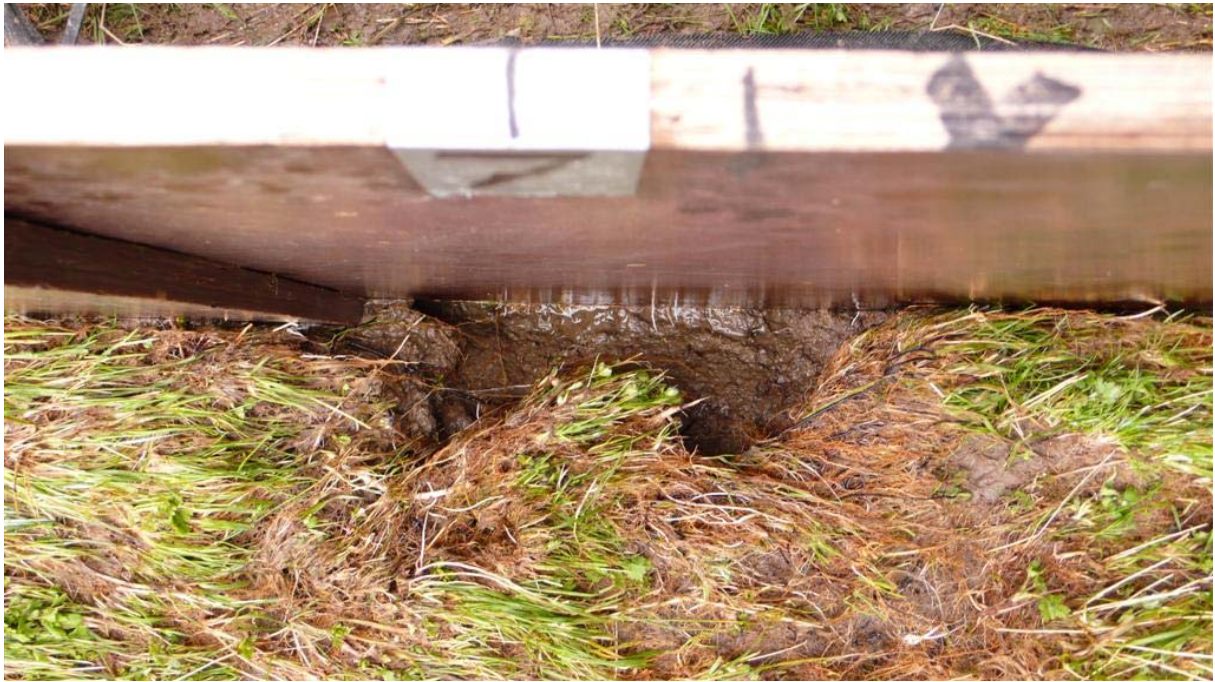
Foto F-1 Randeffecten ter plaatse van de geleideschotten. Om te voorkomen dat als gevolg van deze randeffecten het talud verder zou eroderen zijn deze "gaten" opgevuld met klei en daarna aangetrapt.
