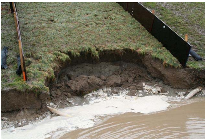
Figuur B21. Eindresultaat Kattendijke, sectie 1. Proef 75 l/s per m gestopt na 5 uur en 40 minuten. Het gat in de onderhoudsweg had het talud bereikt en kroop omhoog langs het talud (head cut erosie). De zandkern was ook hier duidelijk bereikt en de schadeontwikkeling ging vlak voor het stoppen van de proef erg snel. Het talud zelf heeft echter geen wezenlijk schade ondervonden.
