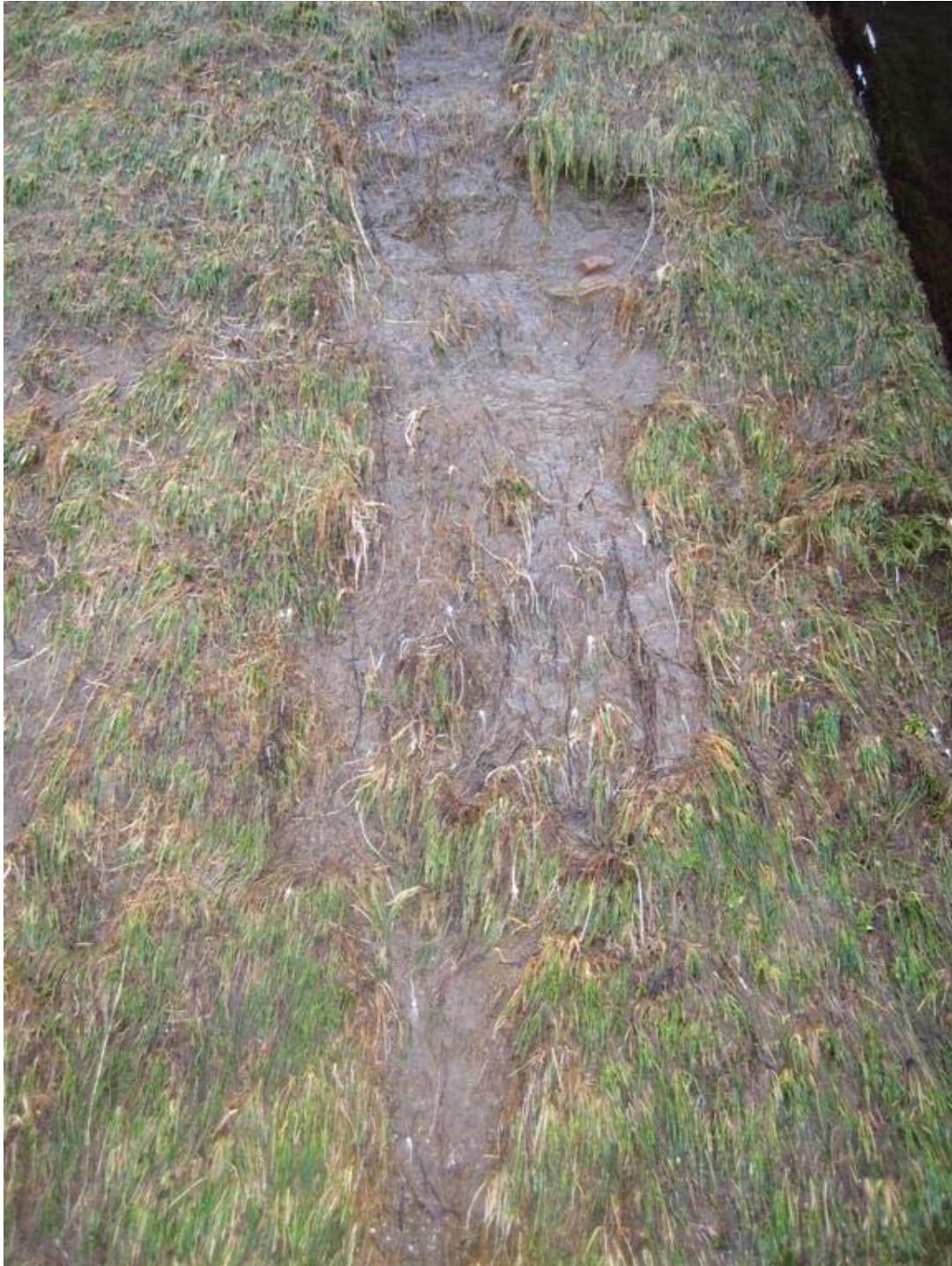
Foto F-4 Het schadebeeld rechts op het talud is gedurende de eerste twee sessies van de proef met 59 l/s per m langzaam groter geworden. In tegenstelling tot het schadebeeld ter plaatse van de meetinstrumenten heeft de schade zich langzaam naar beneden uitgebreid. Ook hier was de schade voornamelijk oppervlakkig.
