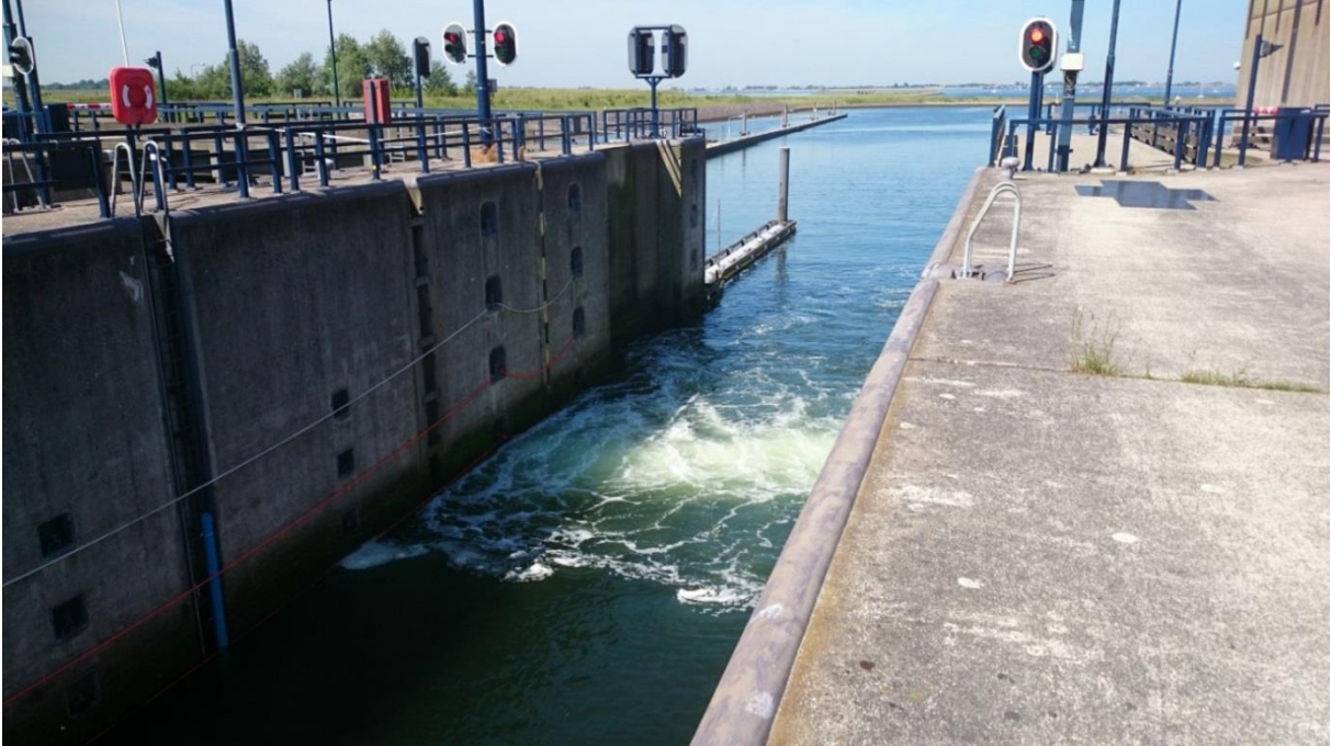
Foto 9. Bellen- en waterscherm bij de Krammerjachtensluis.
