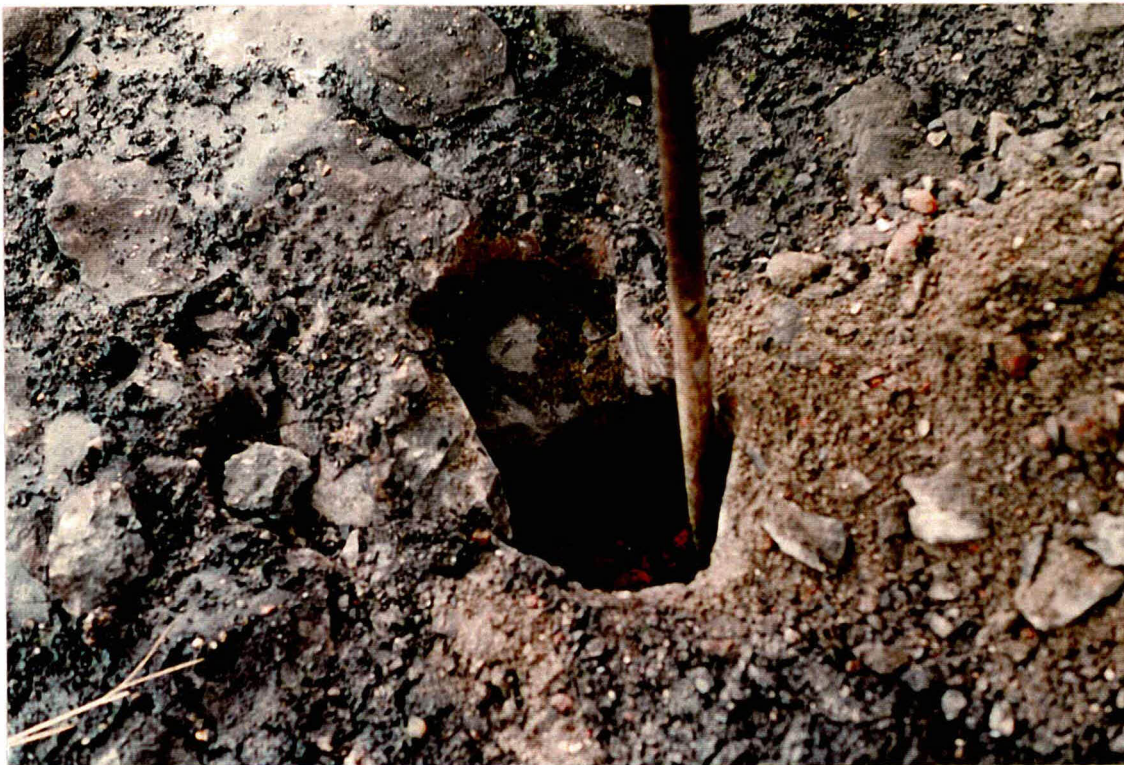
Foto 8 Gat bij dp 36. Het filter is dichtgeslibd, de toplaag moest geheel kapot worden gebroken om een (klein) gat te maken.
