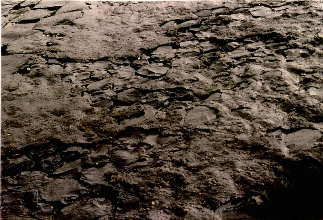
Foto 15 In vak 21 is op sommige plaatsen de penetratie lager op het talud weggespoeld. Tussen de spleten lijkt nog wel asfalt te zitten.
