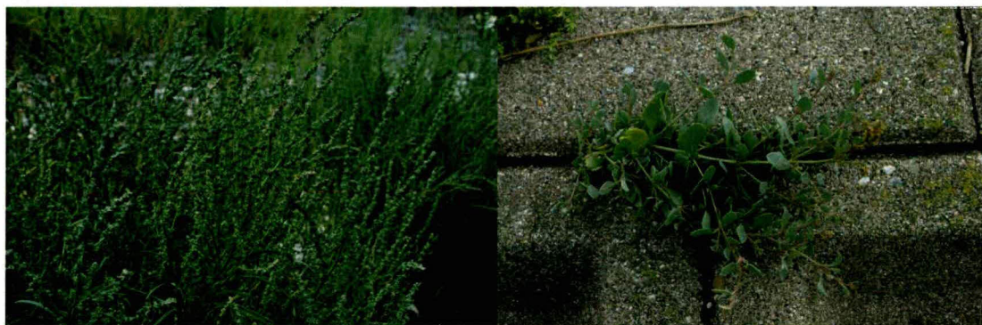
Foto 4.3: Zoutplanten (klein schorrenkruid en gewone zoutmelde) op de steenbekleding van het dijktraject Zandkreekdijk - Wilhelminapolder West.
