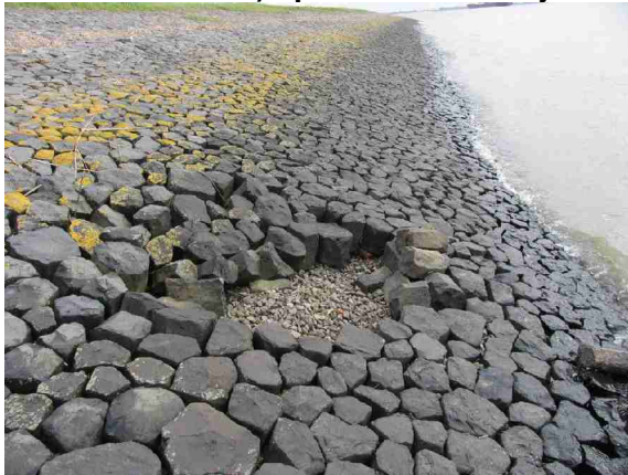
afbeelding 3.4. a) mogelijke schade door toplaaginstabiliteit; b) belasting en stabiliserende krachten op een gezette steen; c) omhoog gerichte waterdruk door golfklap; d) opwaartse druk bij maximale terugtrekking.
