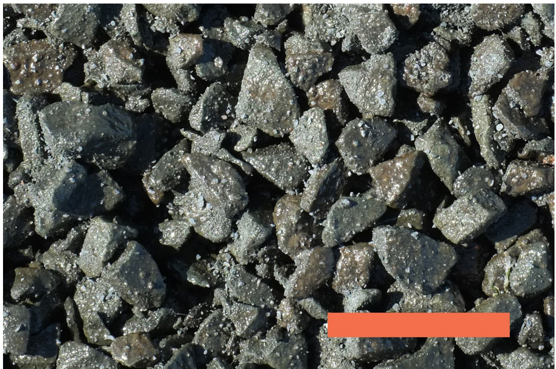
Figuur 1 Elastocoast®, breuksteen verlijmd met polyurethaan met open structuur direct na aanbrengen op de strandhoofden. Het oppervlak van de stenen is verruwd met brekerzand. De maatlijn is 10 cm lang.
