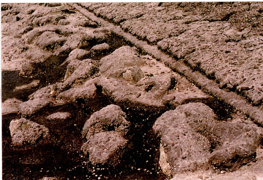
Foto 6 Vochtplek onder de overgang hoog op het talud bij dp 6
