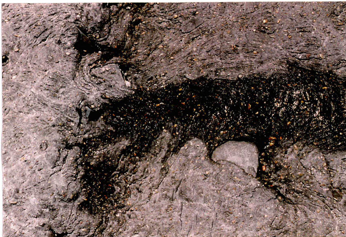
Foto 5: Vochtplek op het talud, laag op het talud bij dp 4
