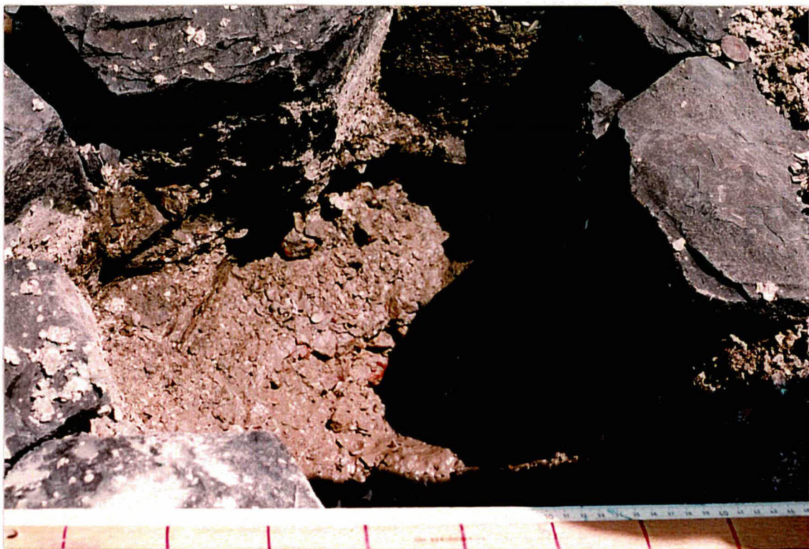
Foto 2 Dichtgeslibd filter bij dp 2
