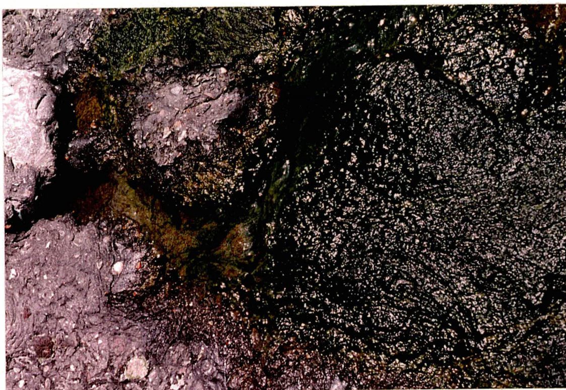
Foto 8 Detail van de vochtplek bij dp 6: er stroomt nog steeds zichtbaar water uit
