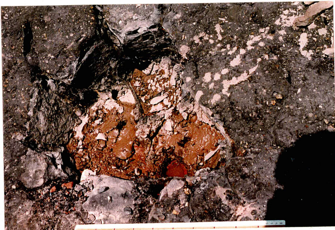
Foto 10 Bruinige sliblaag in het filter bij dp 8 + 80
