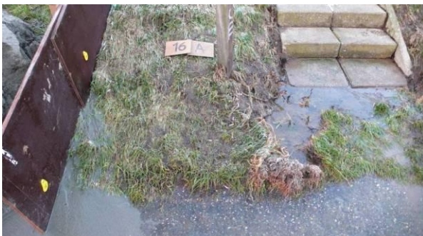
Foto 3.4 Schade teen talud
