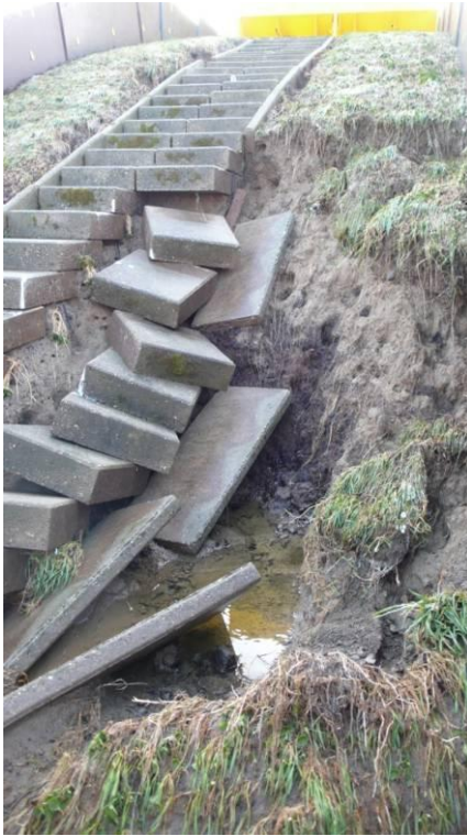
Foto 3.12 Steeds meer treden worden ondermijnd en vallen in het gat
