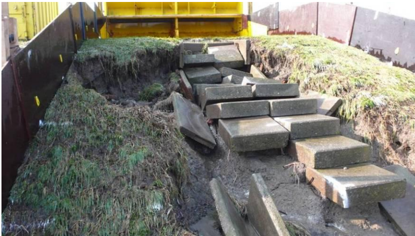
Foto 3.15 Instorting van de trap ter hoogte van de kruin
