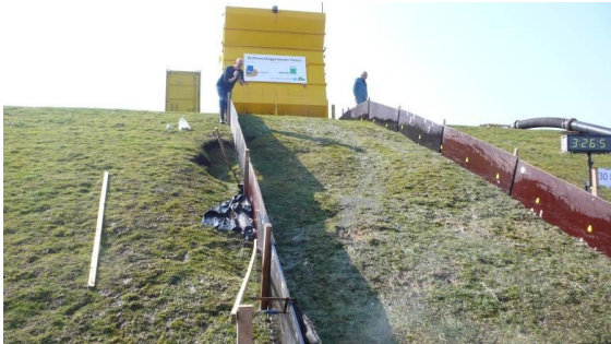
Foto 3.43 Het inzakken van het talud
