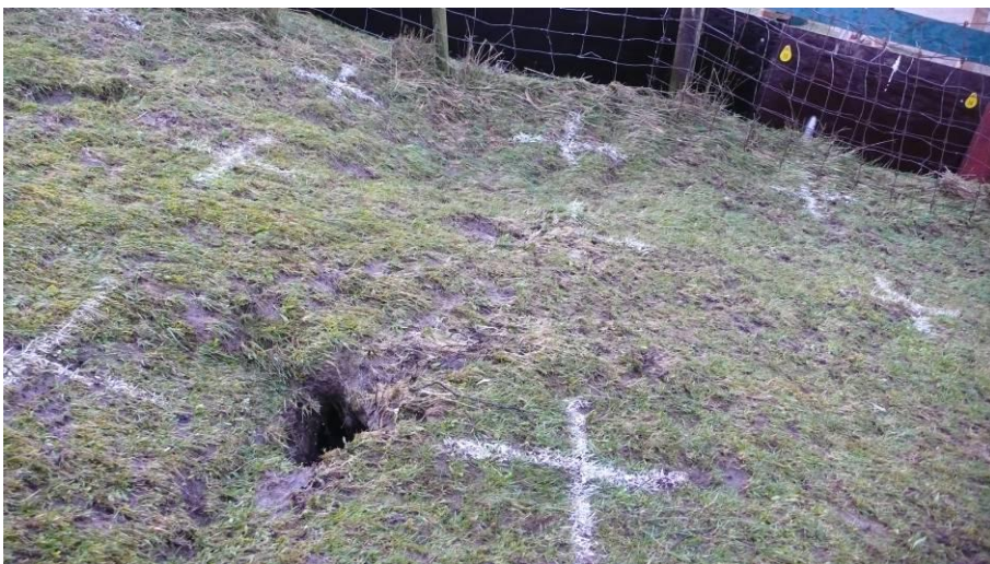
Foto 3.21 Ter hoogte van vak 11B ontstaat een gat
