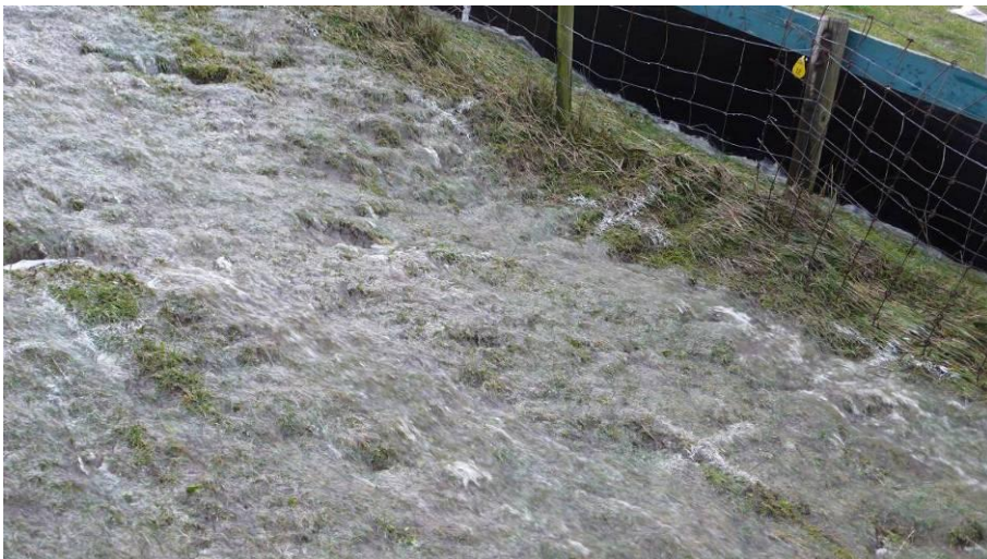
Foto 3.19 Verzakking talud genomen in de tweede sessie na 20 minuten
