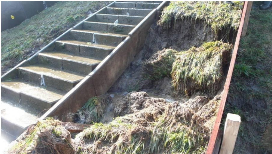
Foto 3.9 Verdergaande erosie gat rechterzijde trap.
