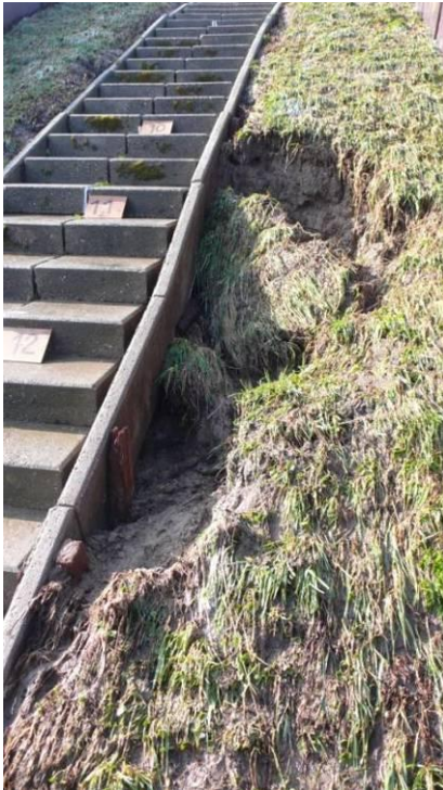
Foto 3.7 Verdergaande erosie in de vakken 10c, 11c en 12c
