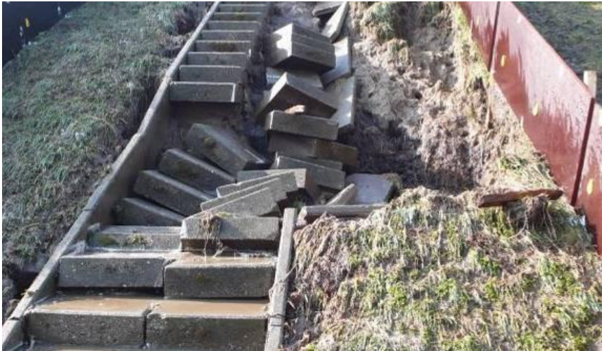
Foto 3.14 Verdergaande erosie en instorting van de trap
