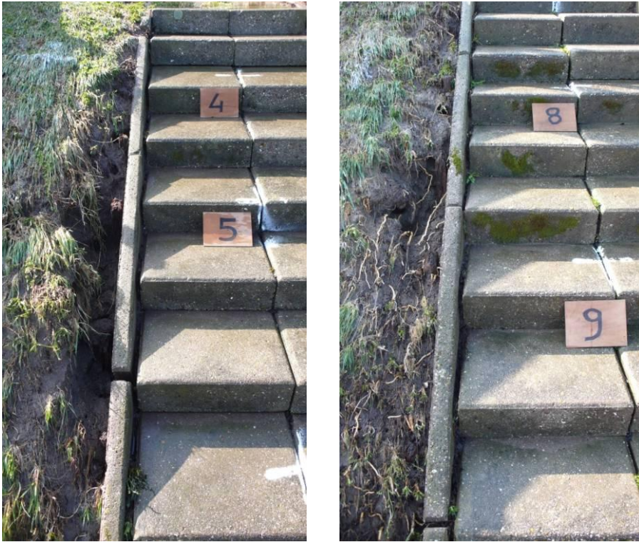
Foto 3.8 Erosie van de kleilaag langs de opsluitbanden in de vakken 4b, 5b en 8b
