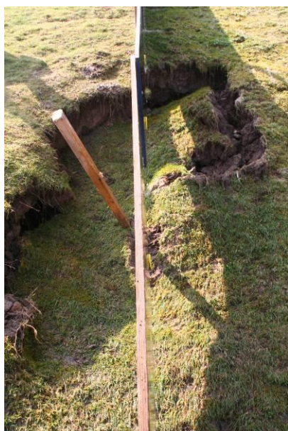
Foto 3.44 Schade (van onderaf gezien)
