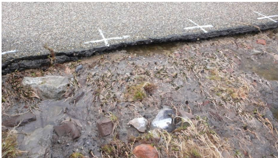
Foto 3.2 Ondermijning asfalt onderhoudsweg
