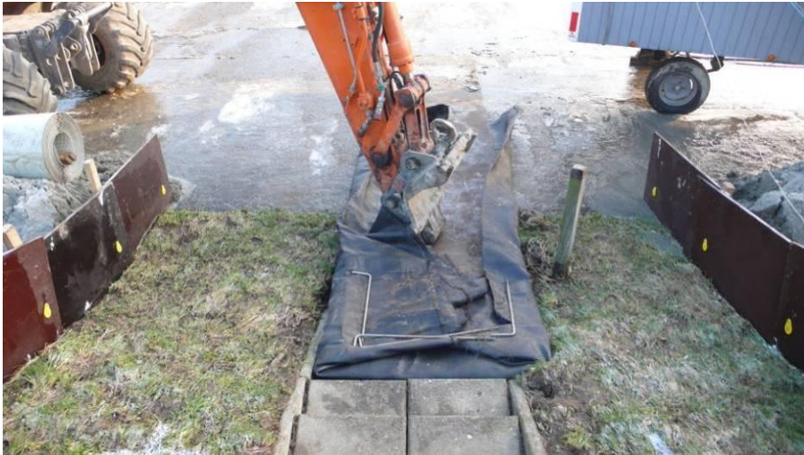
Foto 3.5 Afdekking schade teen talud met geotextiel en rijplaat.
