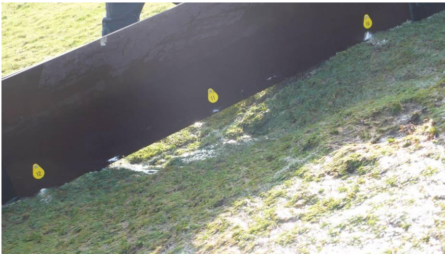
Foto 3.40 Het talud ter hoogte van vak 12A zakt
