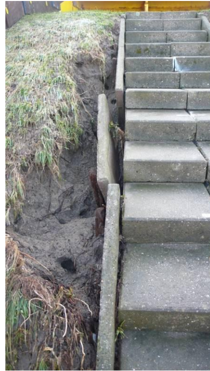
Foto 3.13 Verzakking opsluitband vak 6b
