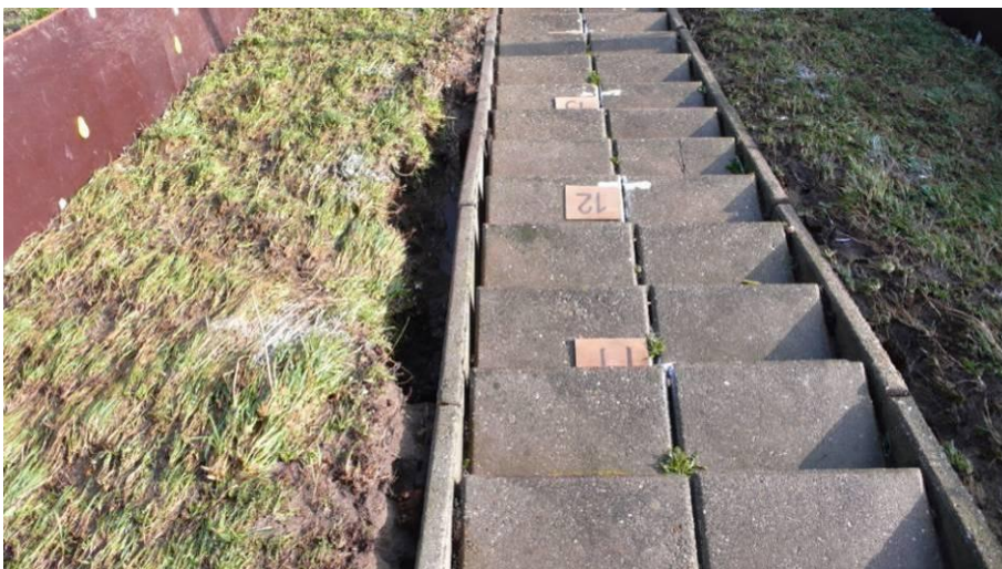
Foto 3.6 Uitbreiding van het gat ter hoogte van de opsluitbanden in vakken 11c en 12c
