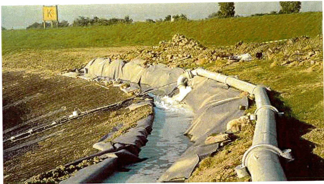
Infiltratiesloot met toevoer van water
