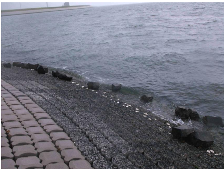
Afbeelding 7. Stormschade en vandalisme leiden tot losraken basaltzuilen met groefwier.
