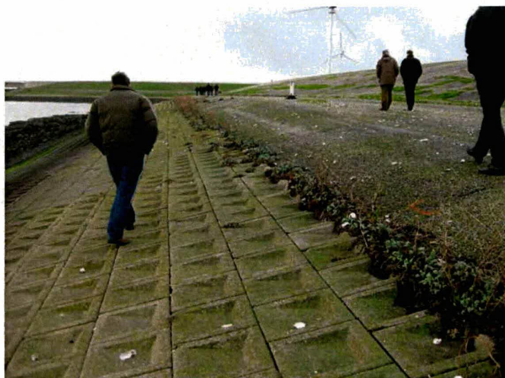
Foto 2 Gele hoornpapaver in de scheuren van de asfaltbekleding aan de zuidoever van de Oosterscheldekant van de Roggenplaat.
