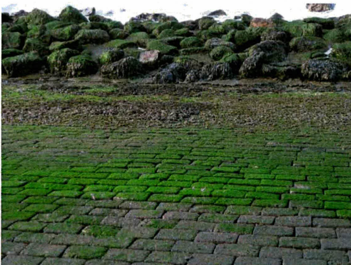
Foto 4 Wieren op de koperslakblokken van de Westelijke Ringdijk.
