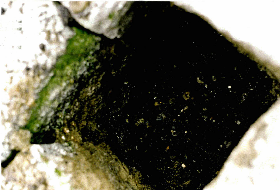
Foto 12 Gat in de bekleding bij dp 58.
